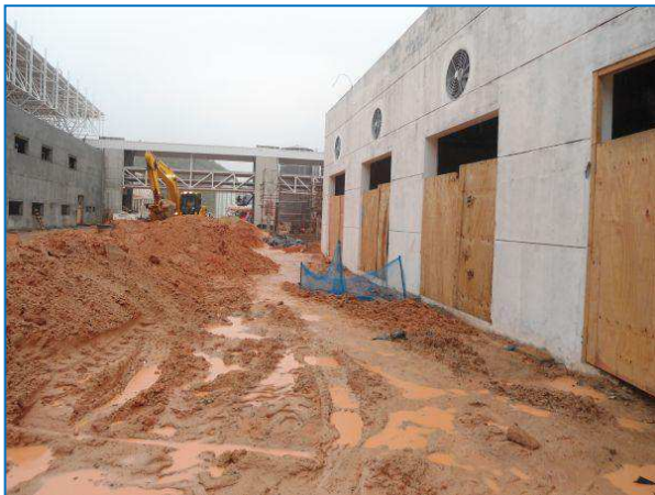
Figura 26 – Acessos da SE utilidades.
