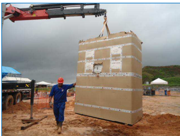
Figura 36 – Acesso à subestação ETDI.
