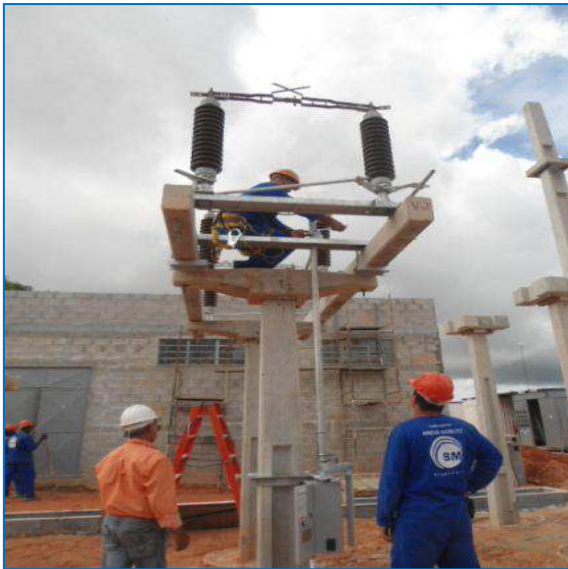
Figura 11 – chave seccionadora da SE 69 kV.
