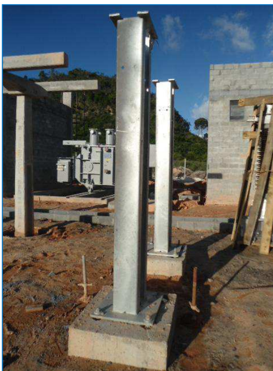
Figura 16 – Suporte do disjuntor montado na SE 69 kV.
