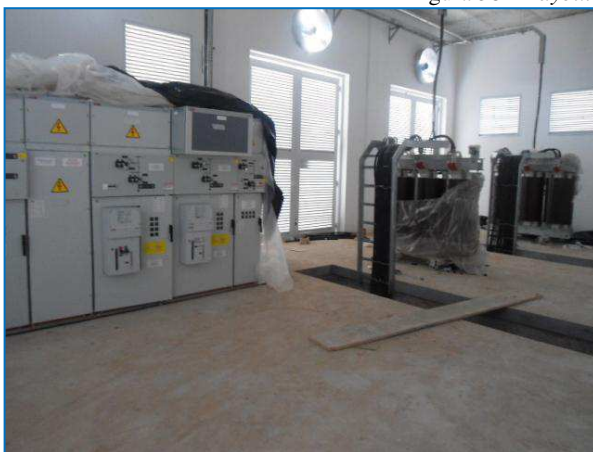
Figura 39 – Equipamentos da subestação ADM.
