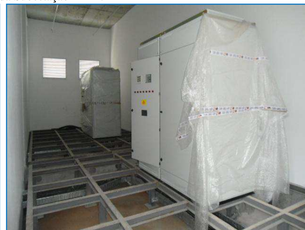
Figura 40 – Equipamentos da subestação ADM.
