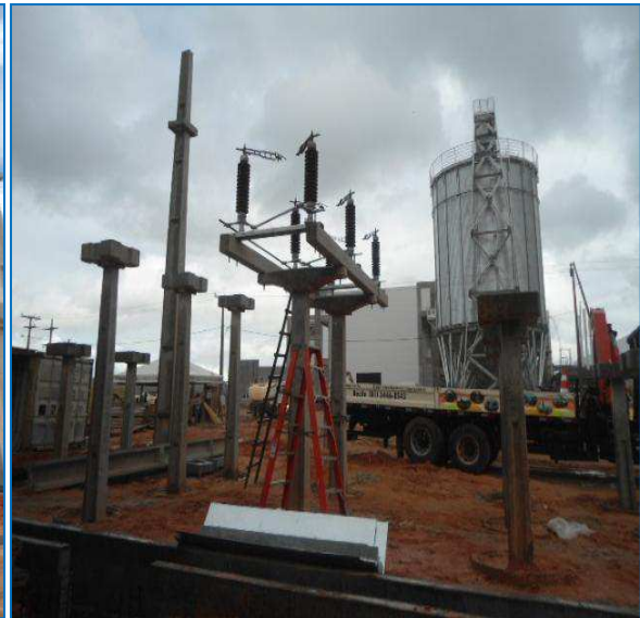
Figura 12 – chave seccionadora da SE 69 kV.
