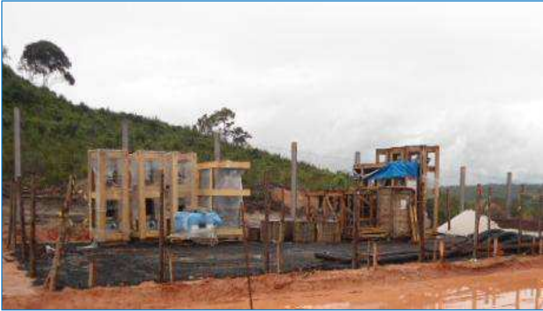
Figura 9 – Área de armazenamento dos equipamentos de pátio da SE 69 kV.
