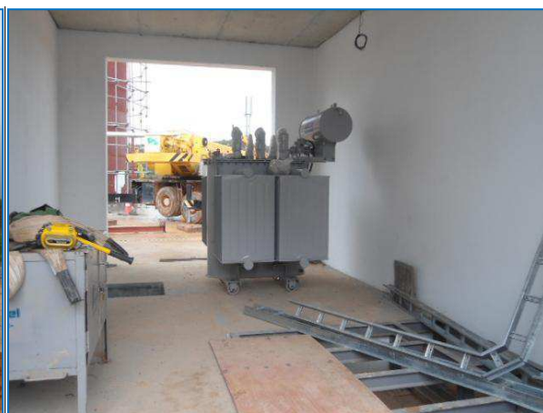
Figura 37 – Acesso à subestação ETDI.
