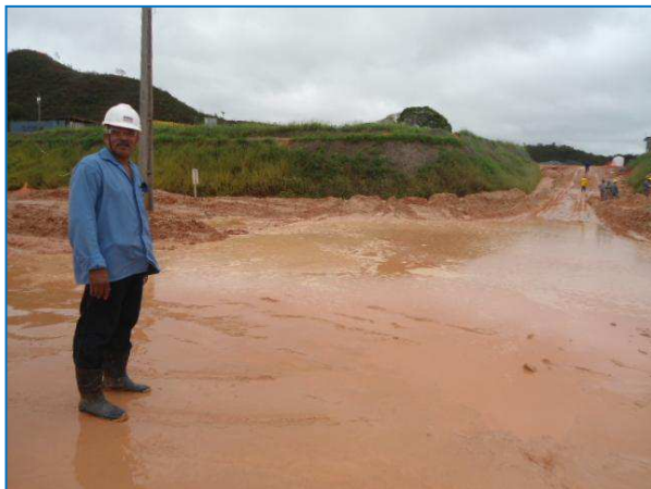
Figura 34 – Acesso à subestação ETDI.
