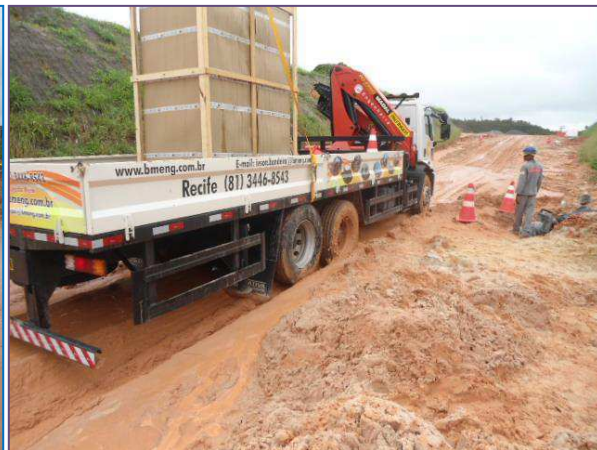
Figura 35 – Acesso à subestação ETDI.
