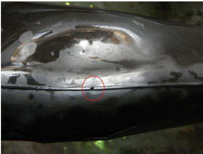
Figura 20- Manga isolante reprovada no ensaio elétrico
