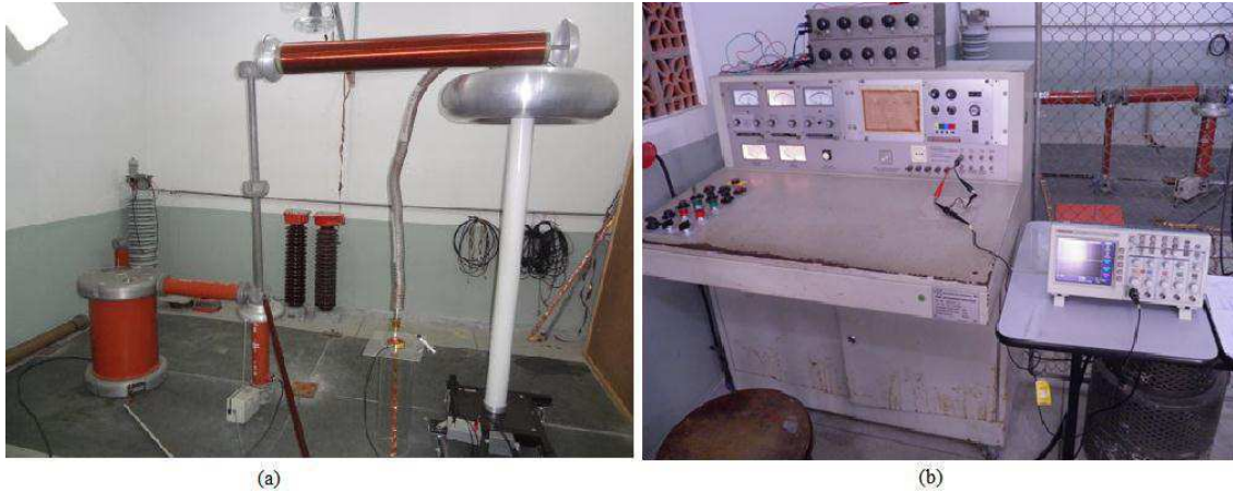
Figura 3- Fotografia da Sala do Kit de Alta Tensão (a) Kit de Alta Tensão e (b) Mesa de Controle
