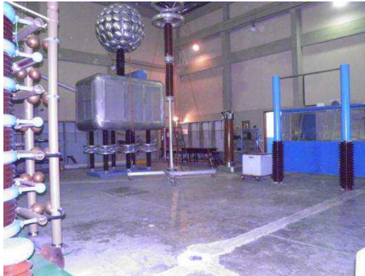
Figura 1- Fotografia do Laboratório de Alta Tensão
