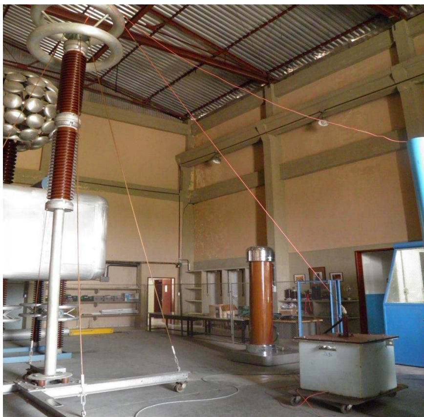
Figura 8-Fotografia do transformador e do divisor de tensão capacitivo
