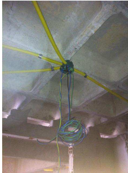
Figura 7. Desperdício de cabos no ponto de iluminação (1d).
