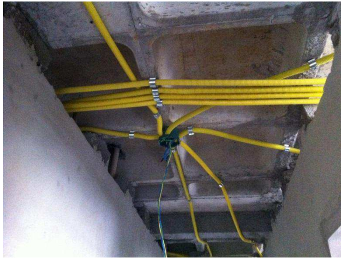
Figura 2. Ponto de iluminação 1g está enviando cinco eletrodutos.
