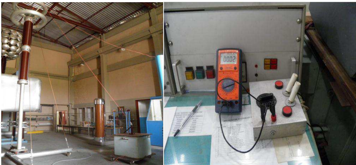
Figura 7 – (a) Fotografia do transformador e do divisor de tensão capacitivo (b) Fotografia do multímetro utilizado para medição da corrente de fuga
