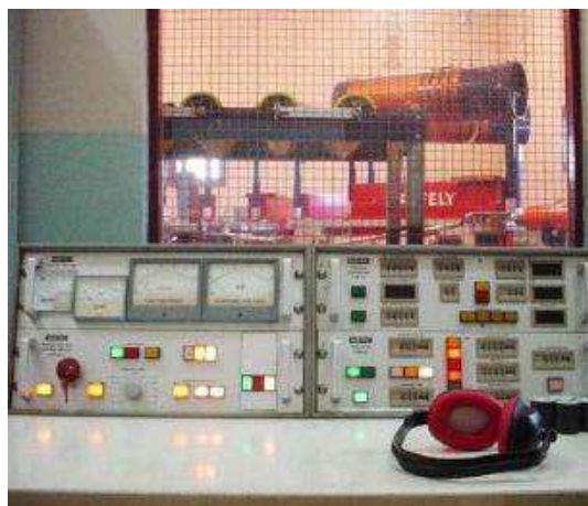
Figura 2 - Fotografia da mesa de controle do gerador.
