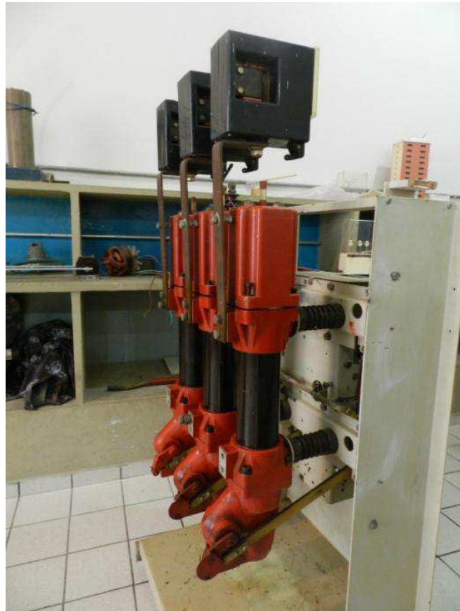
Figura 21 - Fotografias do Disjuntor PVO – Siemens.
