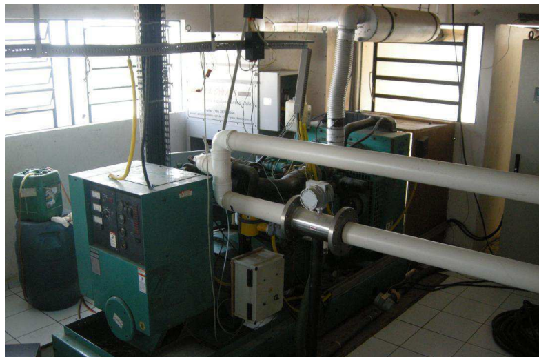
Figura 1: Unidade de termogeração.
