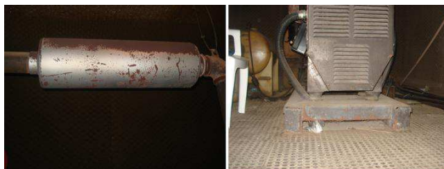
Figura 9 - Escape enferrujado/ Ausência do vibra stop.
