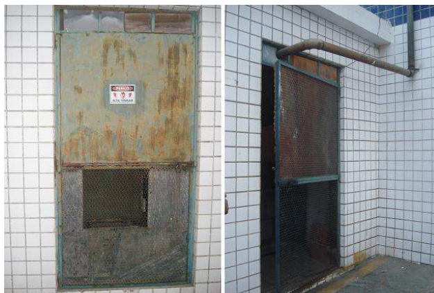
Figura 10 - Ventilação do recinto.
