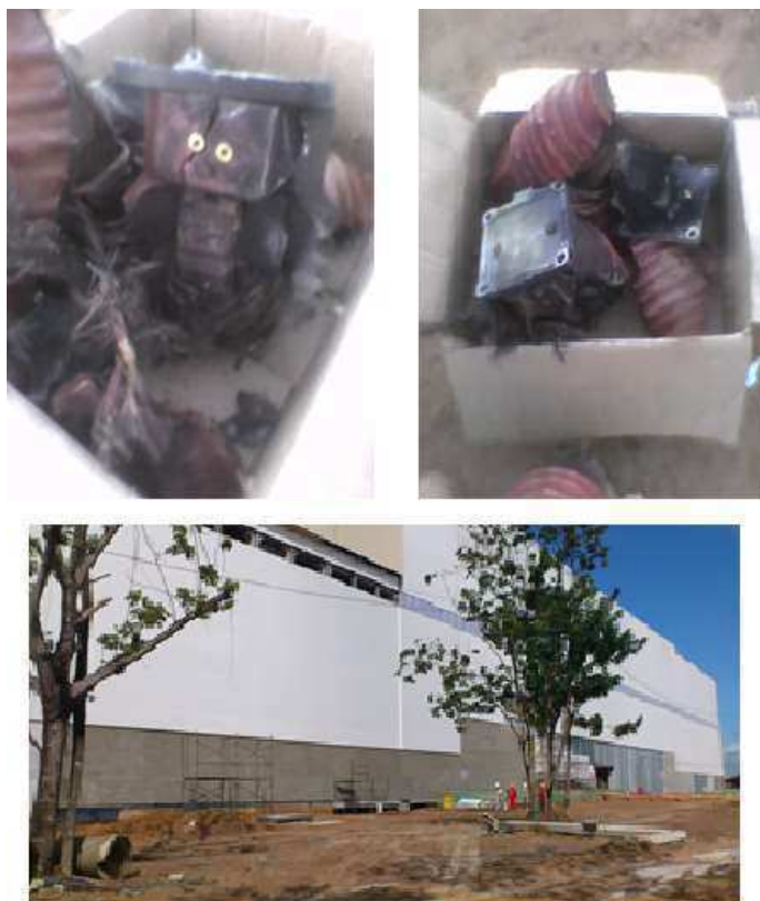
Figura 6: a e b. TC e Tp danificados. c. Poste danificado
