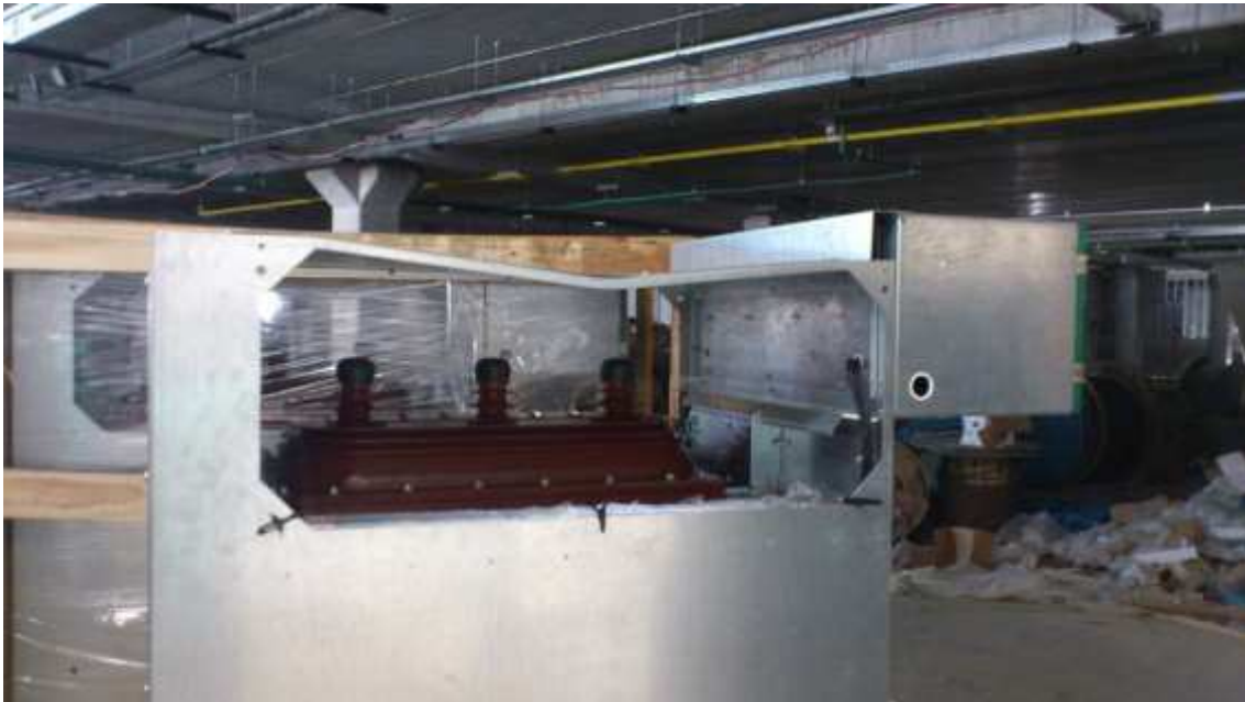
Figura 9: Equipamento danificado durante transporte.
