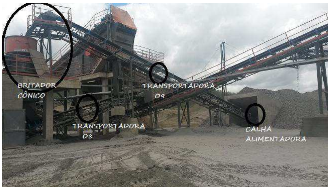
Figura 15: Foto referente ao processo utilizado à linha britagem terciária.
