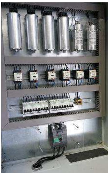
Figura 28: Foto do banco de capacitores 50kvar – linha de britagem primária.
