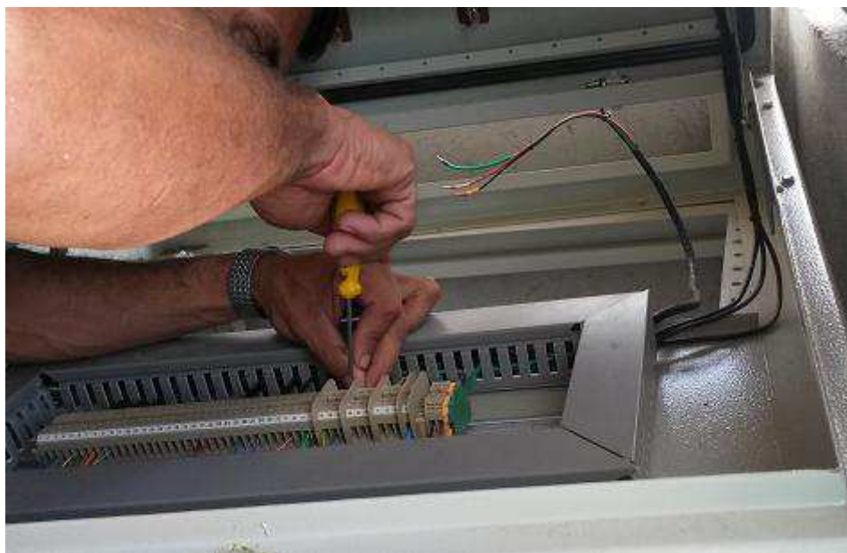
Figura 25: Foto da instalação do comando remoto CCMI-01.
