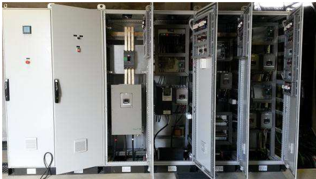
Figura 20: Foto referente aos centros de controle de motores (CCM).
