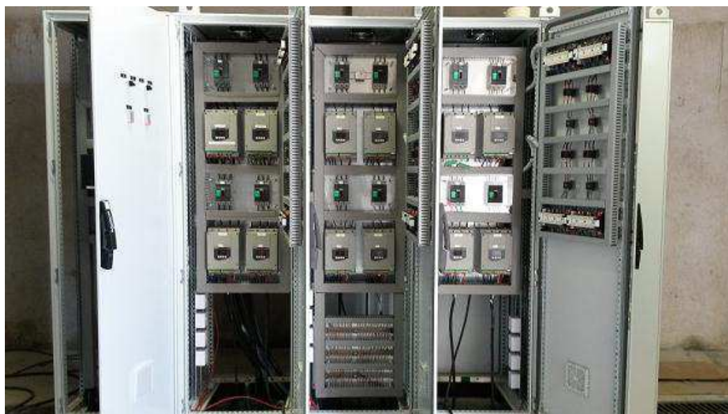
Figura 21: Foto referente aos centros de controle de motores (CCM).
