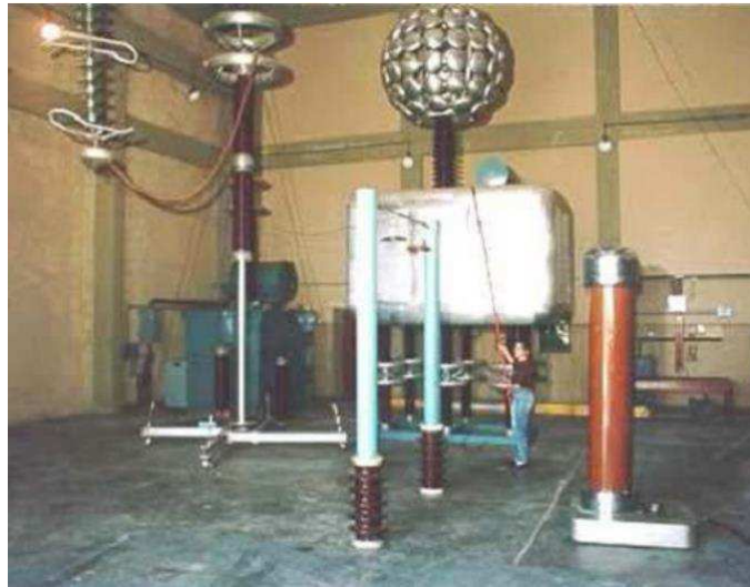
Figura 1. Salão de alta tensão.
