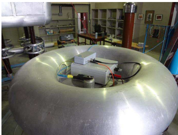
Figura 15. Conexão entre SC5B e o FOT X, entre o SC5B e o objeto teste e conexão da alta tensão com o SC5B e o capacitor padrão.
