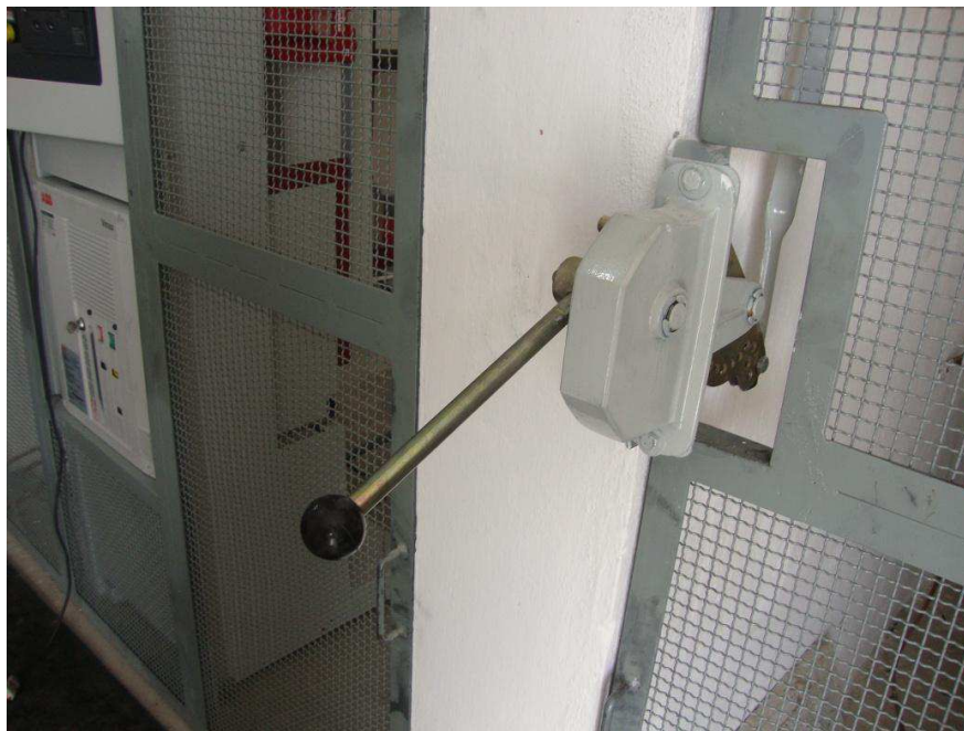
Figura 78 – Alavanca de acionamento da seccionadora.
