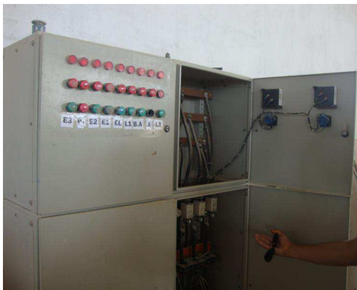
Figura 34 – Quadro Geral de Distribuição da Empresa.
