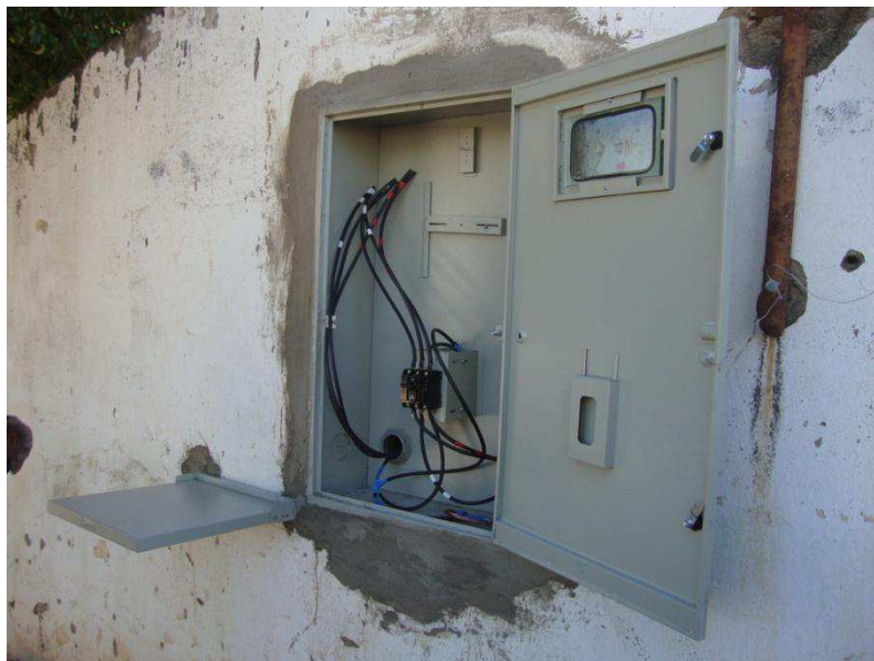
Figura 47 – Vista geral do Quadro de força e medição.
