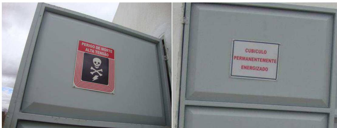
Figura 63 – Placas de Alerta de Perigo na porta de entrada da instalação.
