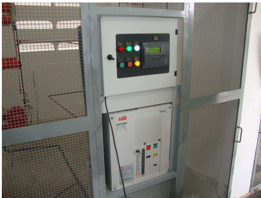
Figura 75 – Interface de controle do disjuntor da cabine 2.
