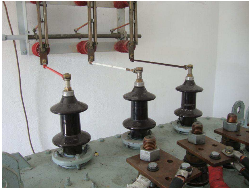
Figura 77 – Conexão da Chave seccionadora ao Transformador na Cabine 3.
