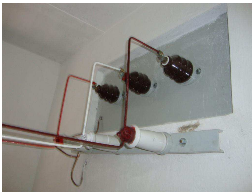
Figura 72 – Saída da Cabine 1 da subestação.
