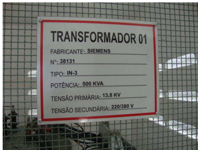
Figura 68 – Placa de aviso sobre especificação do transformador.
