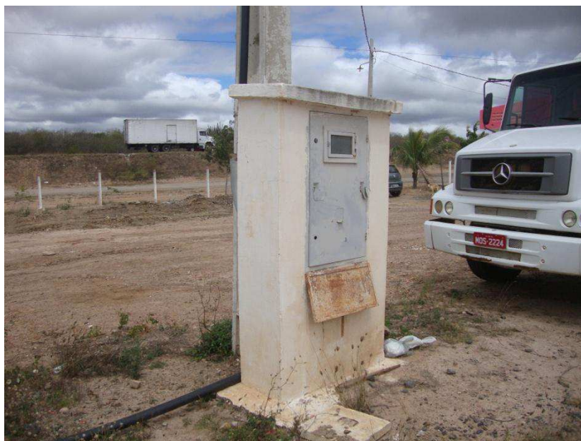
Figura 33 – Quadro de medição já edificado.
