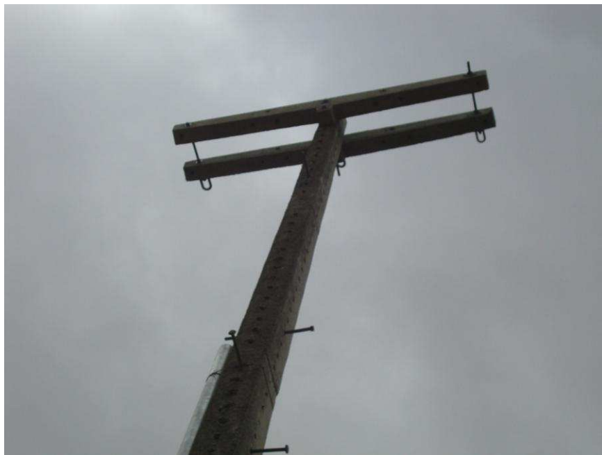
Figura 51 – Poste onde será instalado o transformador.
