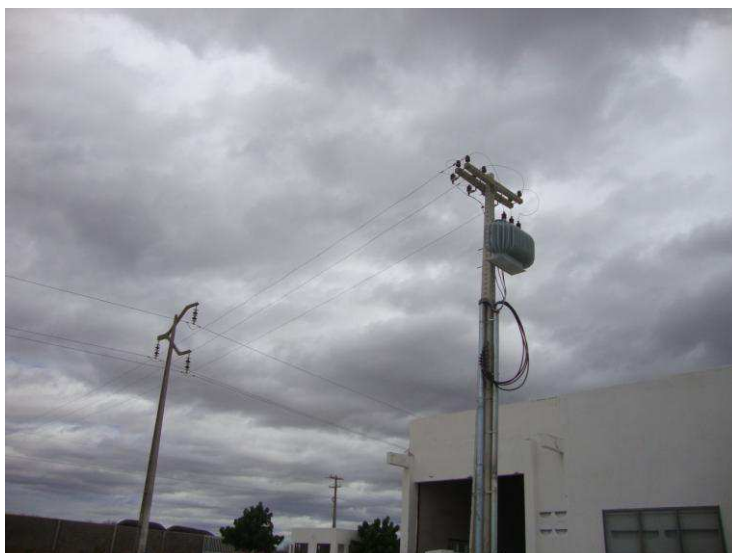
Figura 62 – Vista da linha de entrega de energia.
