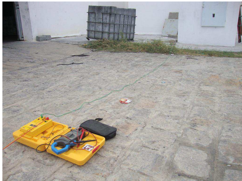
Figura 82 – Teste de medição da resistência de terra com o terrômetro.
