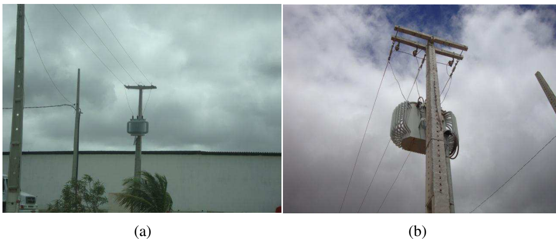
(a) (b) Figura 32 – Destaque do poste com transformador instalado ao lado do poste a receber o segundo transformador de alimentação.
