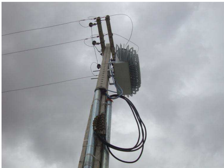
Figura 61 – Transformador de alimentação atual da empresa e os cabos da nova instalação abrigada.
