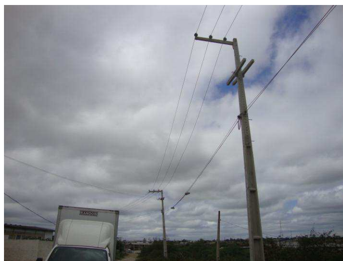
Figura 55 – Rede local de onde será realizada a ligação de energia à empresa.
