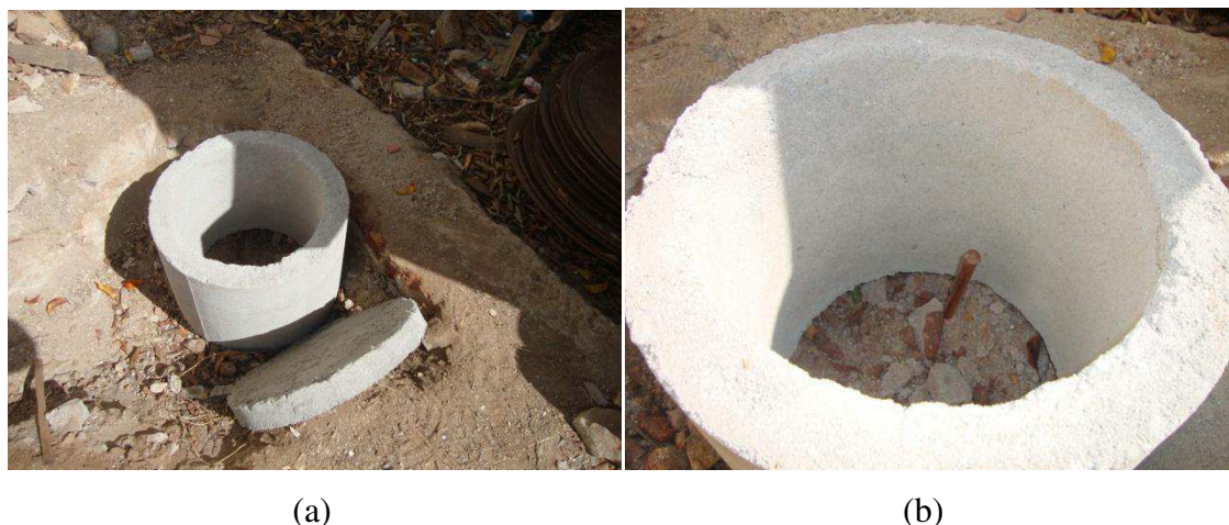
Figura 40 – Invólucro de concreto das hastes de aterramento
