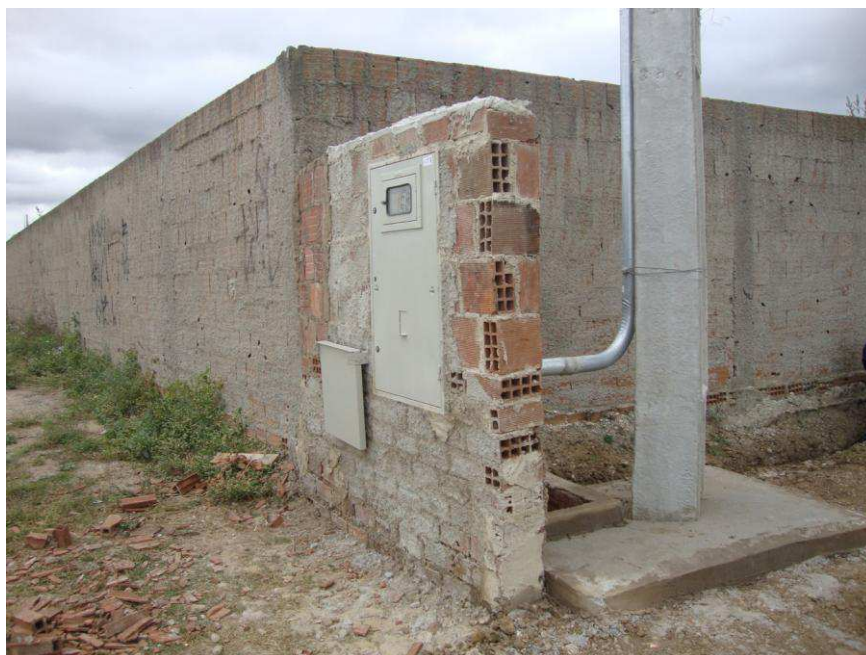
Figura 52 – Quadro de medição da Subestação de Baixa Tensão.
