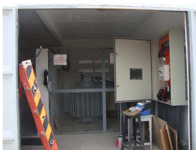
Figura 70 – Vista de entrada da subestação.
