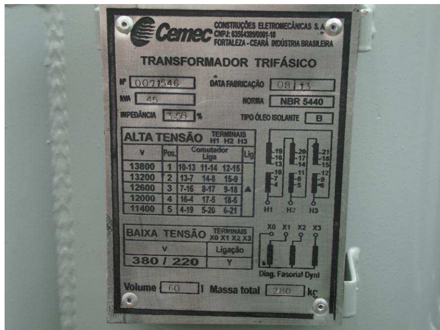
Figura 50 – Placa de Identificação do Transformador.
