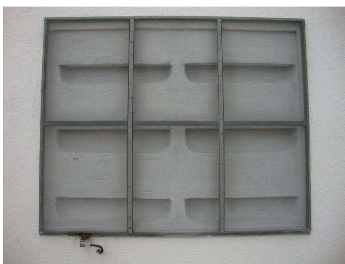
Figura 65 – Janela de ventilação isolada por grade e aterrada.
