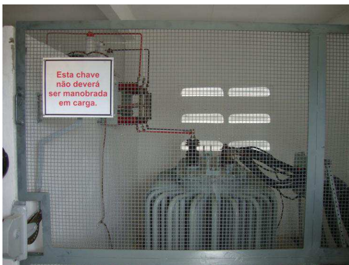
Figura 67 – Placa de aviso sobre operação indevida das chaves.
