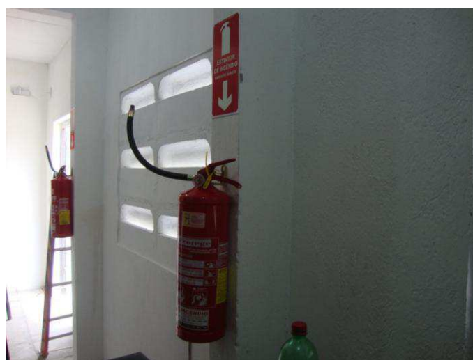
Figura 69 – Extintores de incêndio com fácil acesso e sinalizados.
