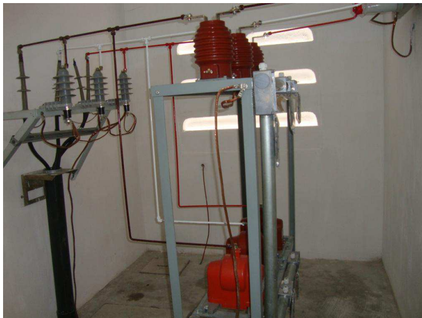
Figura 71 – Cabine 1 da subestação abrigada.
