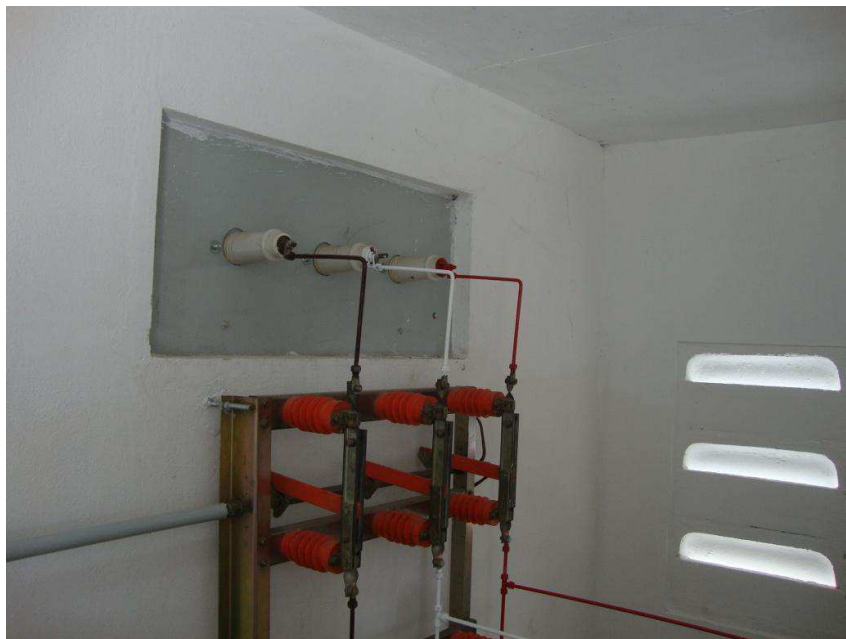
Figura 73 – Entrada da Cabine 2 da subestação e primeira chave seccionadora trifásica.
