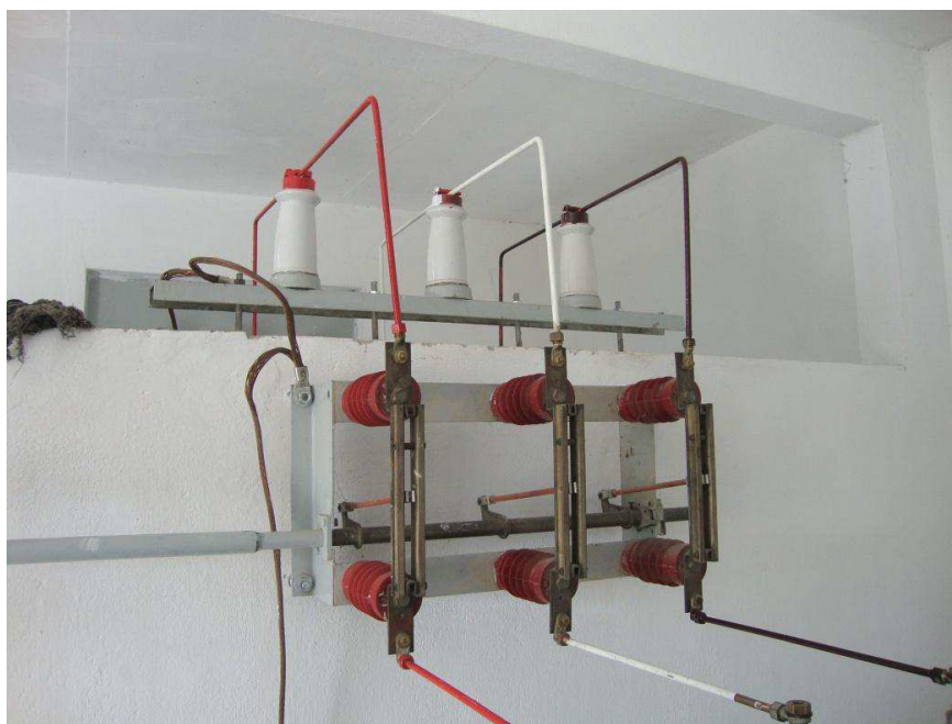
Figura 76 – Entrada da Cabine 3 e segunda chave seccionadora trifásica.
