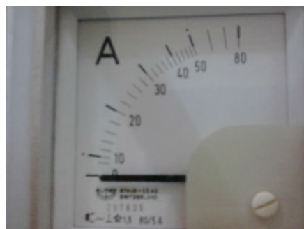
Figura 4.16 – Medidor da corrente do transformador.
