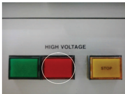
Figura 4.19 – Botão para desligamento do transformador e aterramento do secundário.
