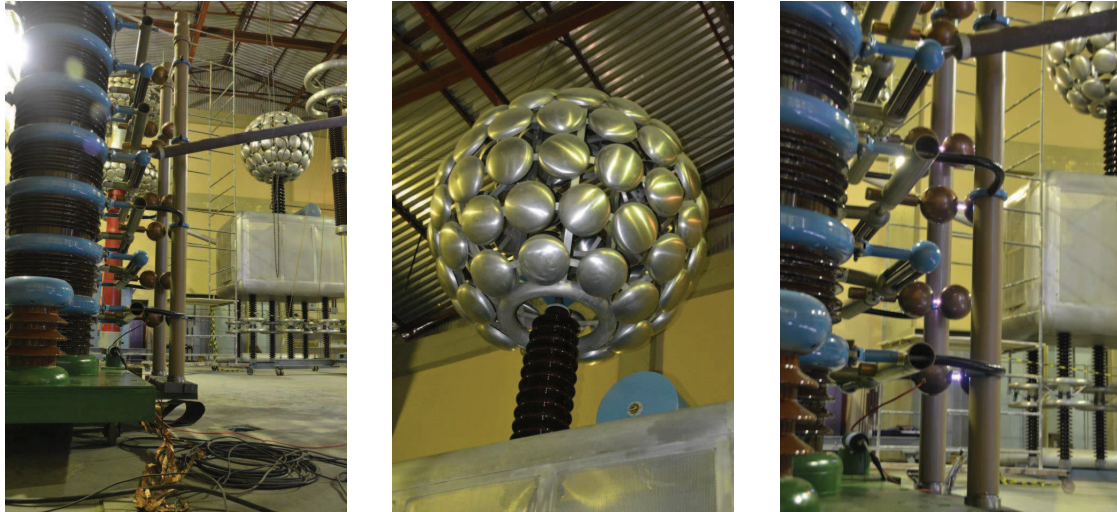
(a) Salão de Alta Tensão do LAT. (b) Terminal da Cascata de Transformadores (até 600kV). (c) Gerador de Impulso de Tensão funcionando.
