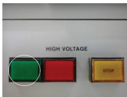
Figura 4.13 – Botão para ligar o transformador.
