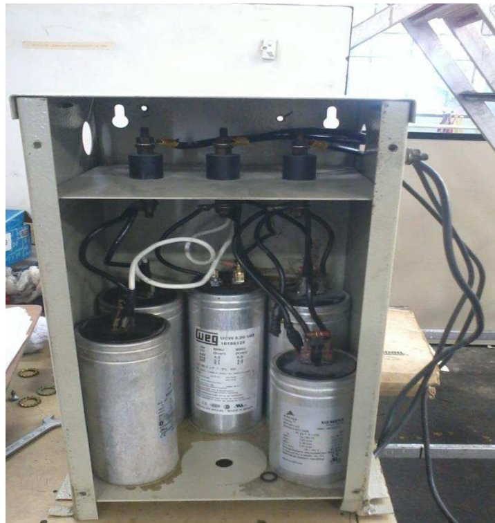
Figura 6. Banco de capacitores para o reciclado.
