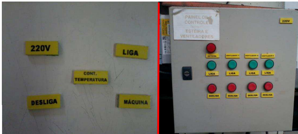
Figura 9. (a) Placas de acrílico. (b) Painel elétrico revitalizado.
