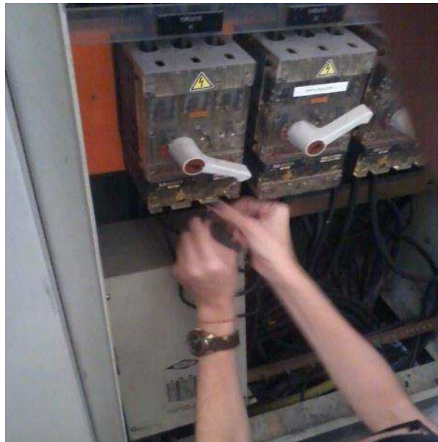
Figura 7. Instalação de um banco de capacitores em um painel.
