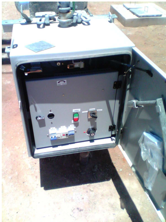
Caixa de comando da chave motorizada.
