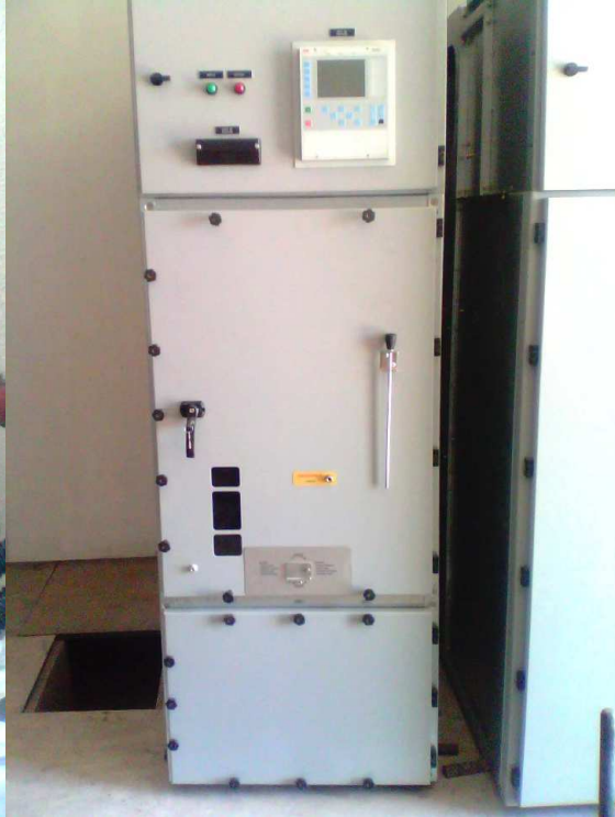
Figura 12 – Cubículo de média tensão
