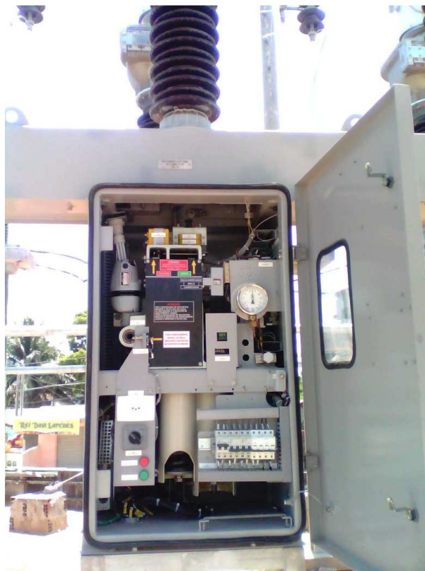
Painel do disjuntor de 69 kV.
