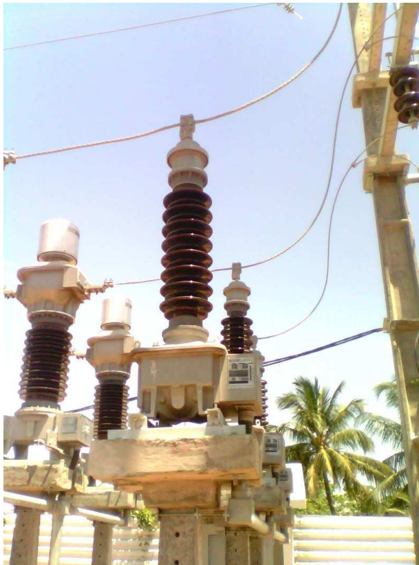
Transformador de Potencial.
