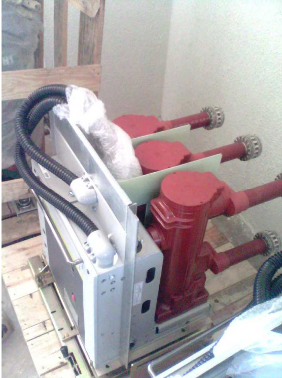
Figura 11 – Disjuntor de 13,8 kV
