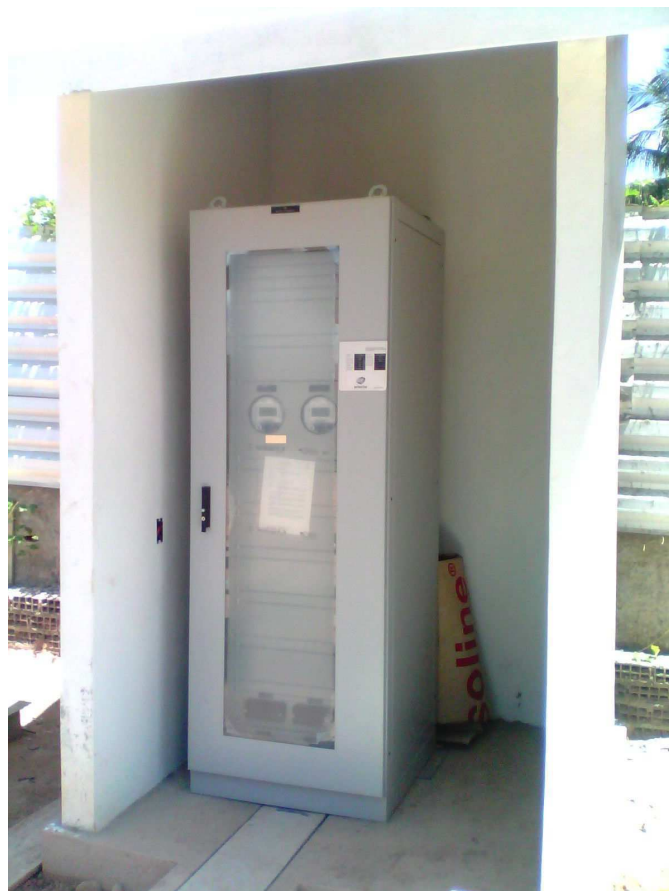
Painel de medição abrigado.
