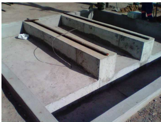
Figura 4 – Base do trafo e caixa coletora.
