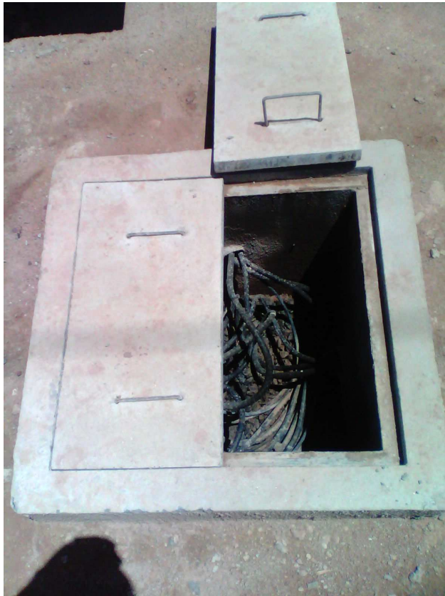
Caixa de passagem para cabos de interligação.
