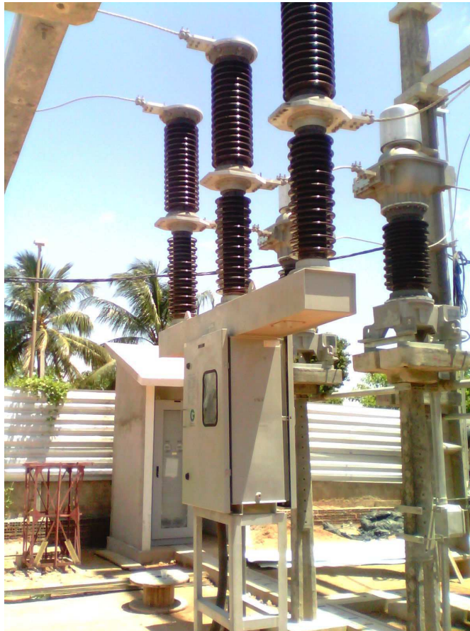
Disjuntor de 69 kV a gás SF6.
