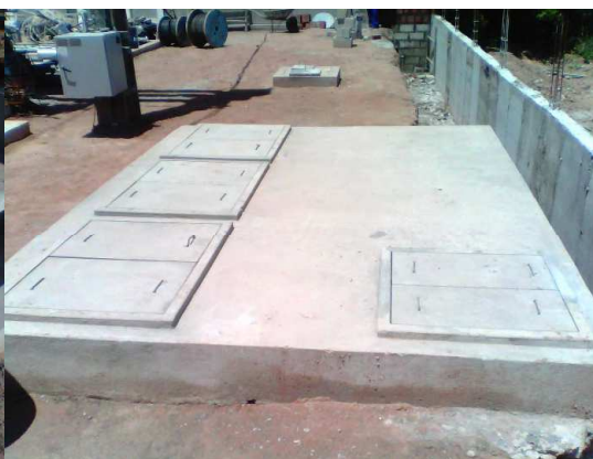
Figura 5 – Caixa separadora de óleo.
