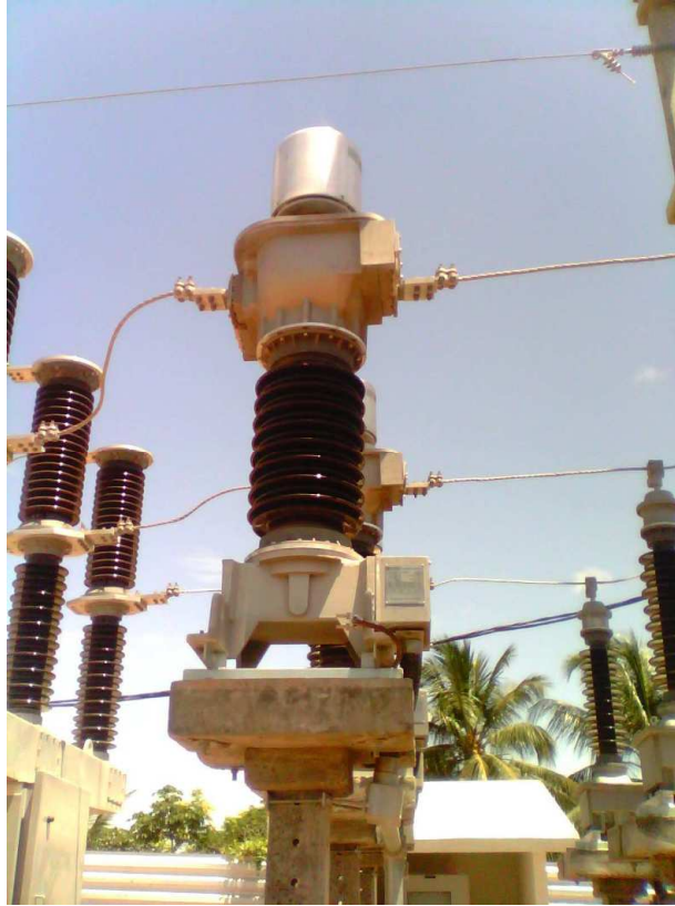
Transformador de Corrente.
