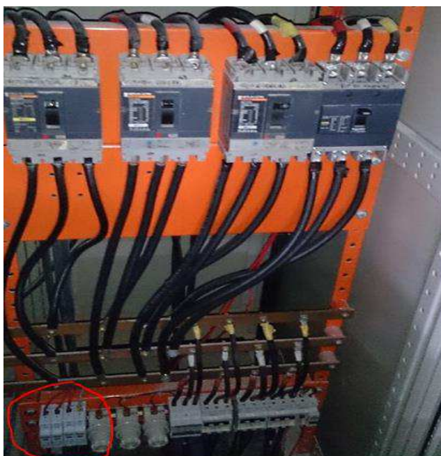
Figura 24 – DPS instalado em quadro QGBT da Silvana
