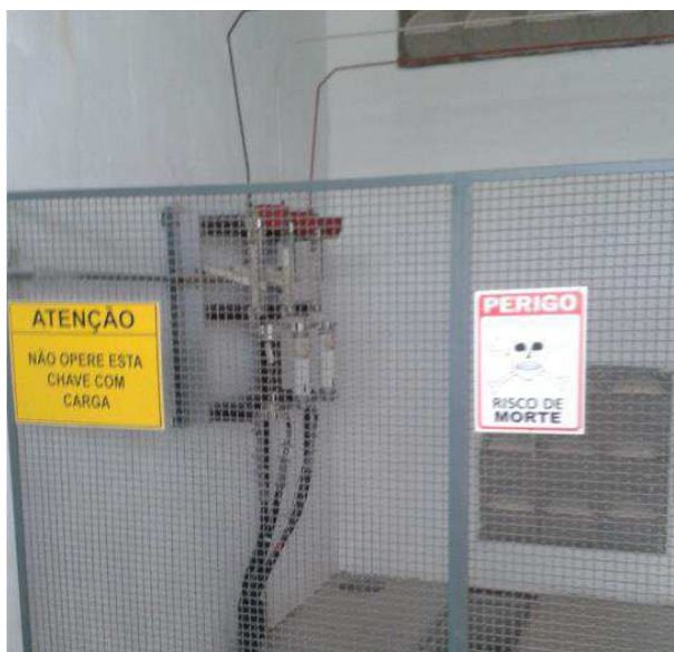
Figura 36 – Sinalização nas Subestações.
