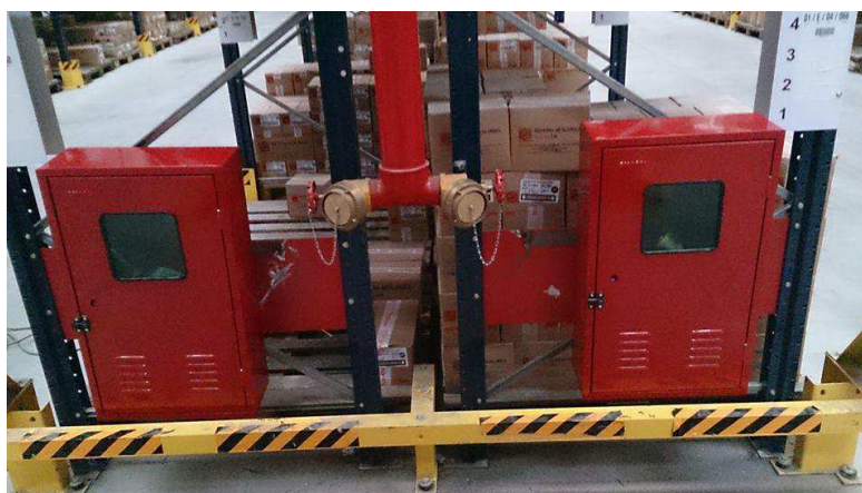
Figura 35 – Abrigos instalados no CD
