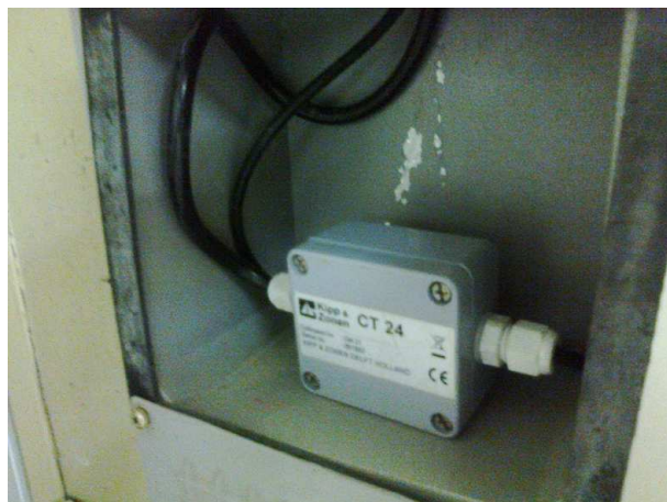
Figura 4.2: Fotografia do amplificador de sinal instalado na parte interna do laboratório.
