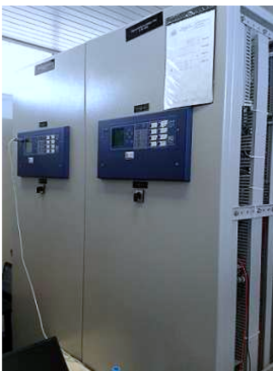
Figura 4.11 – Painéis de proteção de linhas de 500kV.
