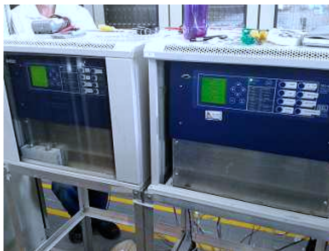
Figura 4.15 – Fotografia de relés curinga em funcionamento na SE RCD.
