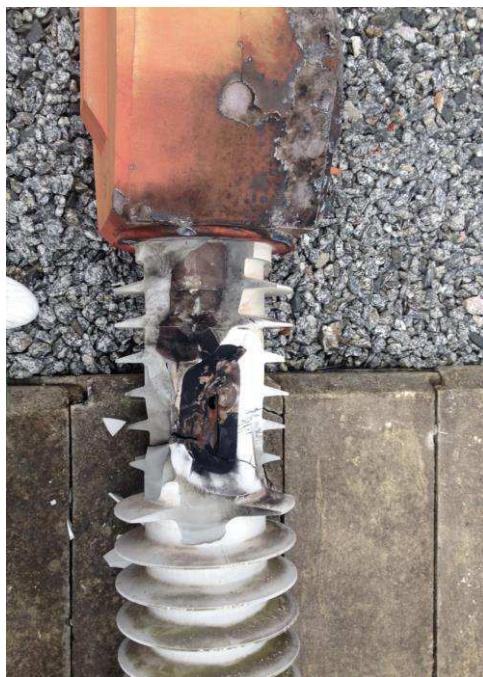
Figura 4.6. TC de medição danificado.
