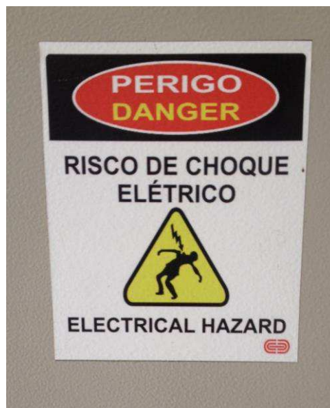
Figura 4.3. Sinalização de segurança em cubículos de alta tensão.
