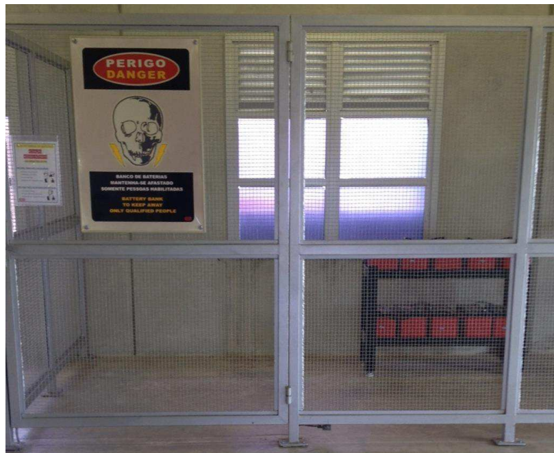
Figura 4.2. Sinalização de segurança em grade de proteção de banco de baterias.
