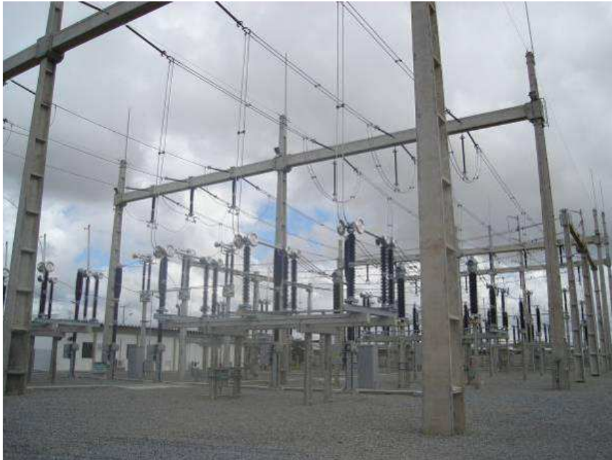
Figura 3.4. Parte da subestação pertencente à CHESF.
