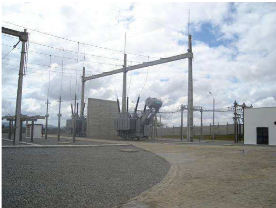
Figura 3.5. Parte da subestação pertencente à COTEMINAS.
