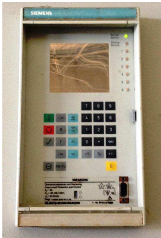
Figura 4.1. Relé de proteção 7SJ5315.
