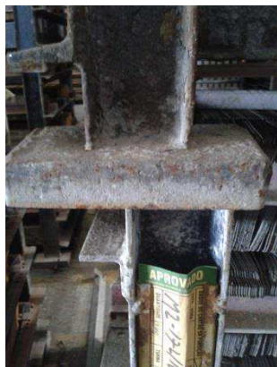
Figura 28: Desalinhamento entre colunas dos cavaletes de placas.
