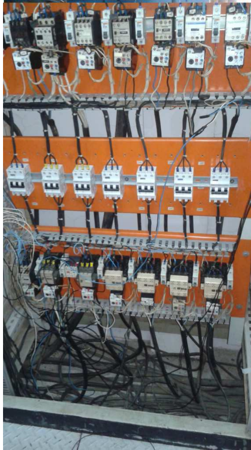
Figura 33 - Painel de comando para o acionamento das bombas de mel.
