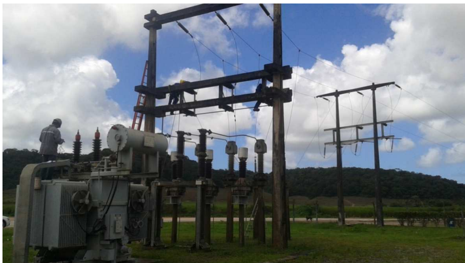
Figura 24 - Subestação de 69 kV com seus equipamentos.
