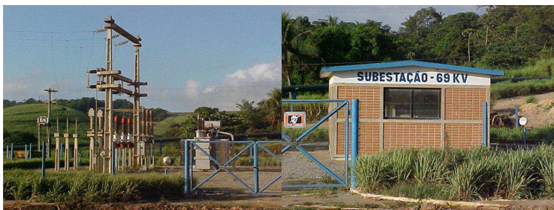
Figura 22 - Subestação de 69 kV.
