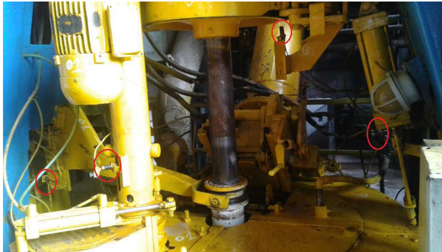
Figura 34 - Sensores instalados nas turbinas centrífugas de açúcar.
