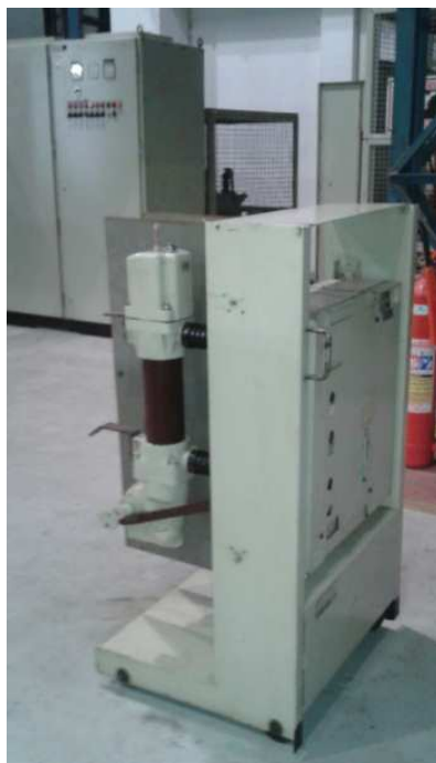
Figura 26 - Disjuntor extraído do cubículo.
