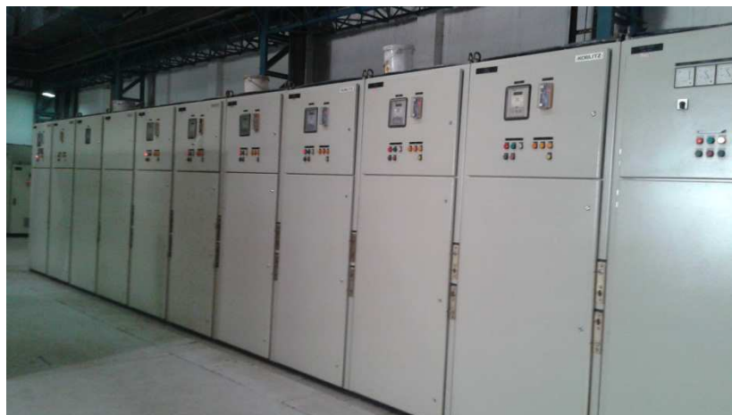
Figura 21 - Cubículos de força dos diversos setores da usina.
