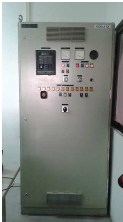
Figura 35 - Painel de excitação do Gerador 1.
