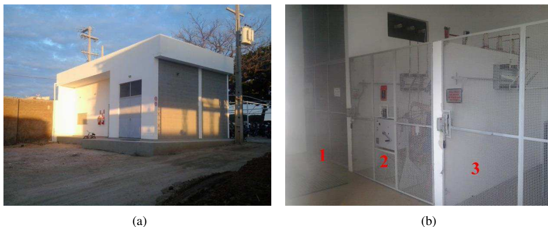
Figura 19 – Subestação do prédio de envase da empresa Engarrafamento Coroa Ltda. (a) vista externa (b) vista interna.
