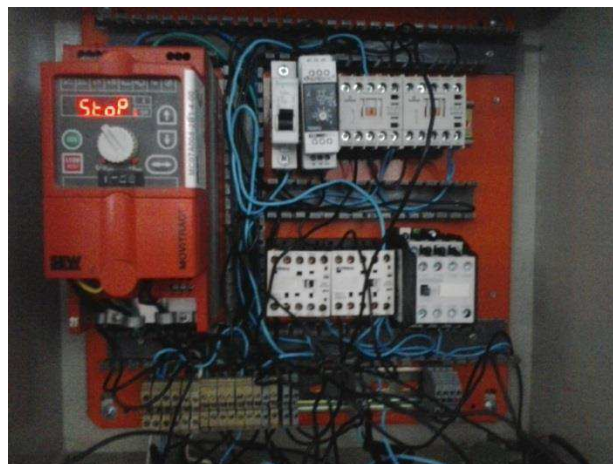
Figura 24 – Quadro de comando do empurrador.
