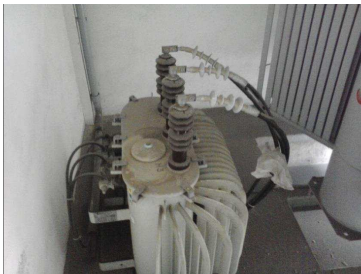
Figura 17 - Transformador de 100kVA que foi removido da SE-05
