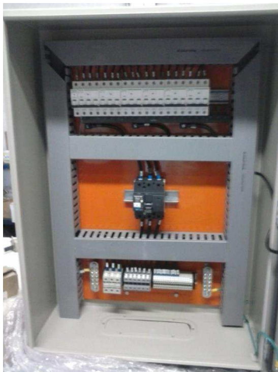
Figura 11 – Fotografia do novo quadro elétrico da expedição.
