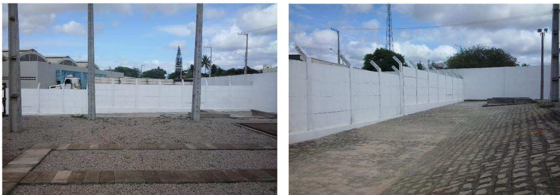
Figura 15 – Parte interna da subestação SE-69 após as melhorias realizadas
