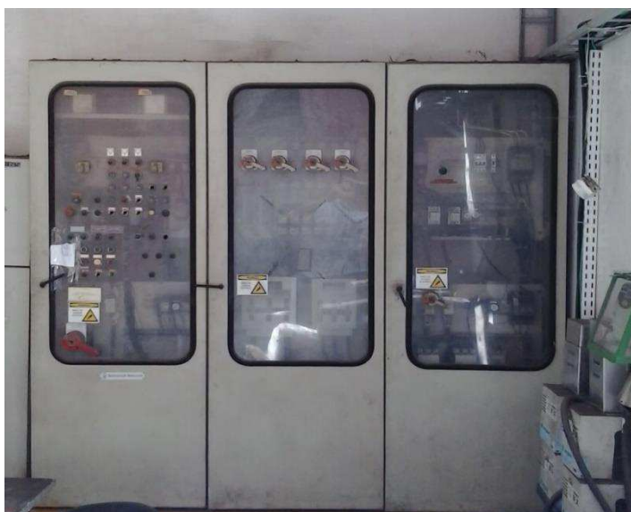
Figura 12 - Quadro elétrico atual da montagem
