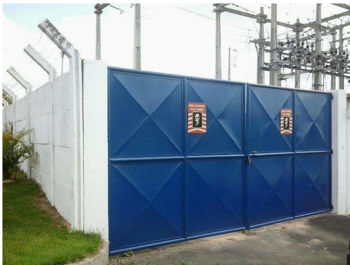
Figura 13 - Subestação pintada e com nova sinalização. Assim como esta, todas as outras subestações da fábrica receberam as mesmas ações.
