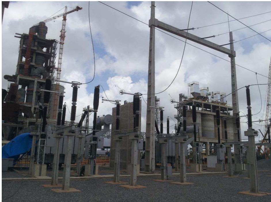
Figura 17. Subestação no interior da empresa Brennand Cimentos
