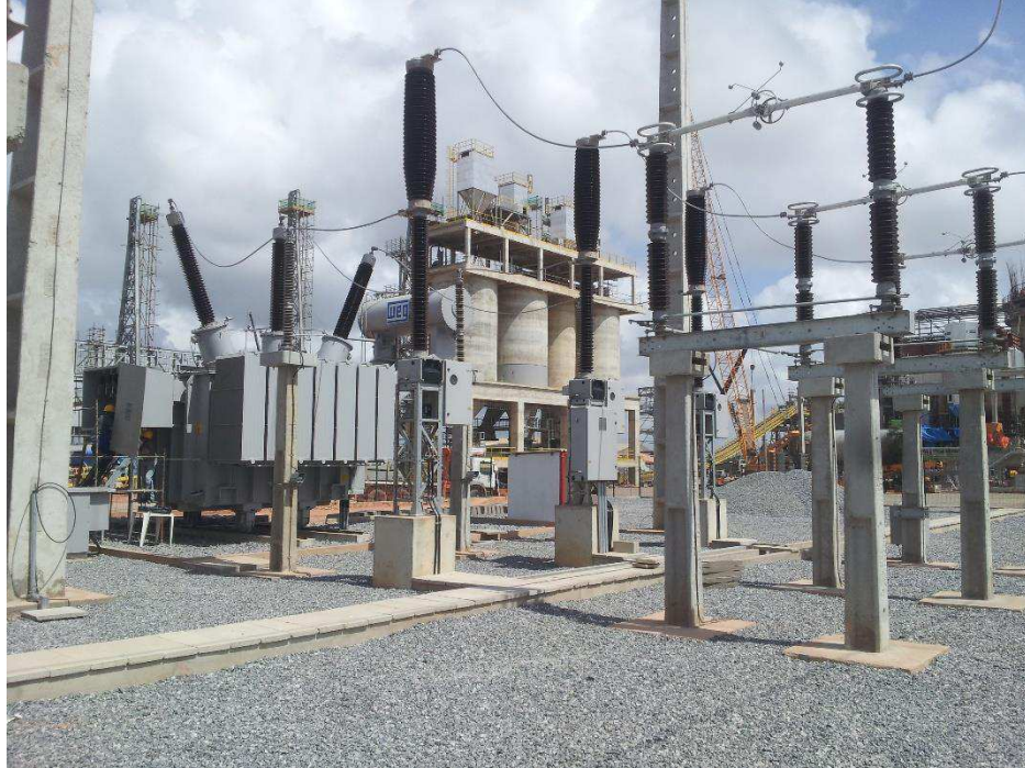
Figura 16. Subestação no interior da empresa Brennand Cimentos
