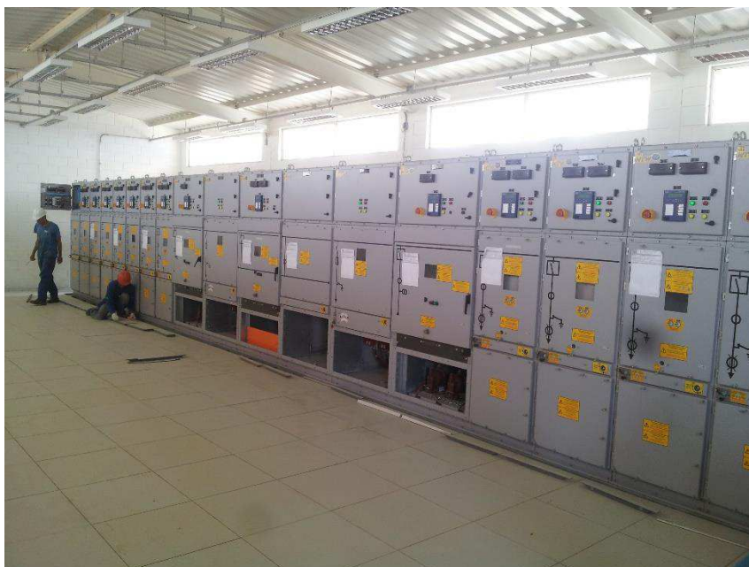
Figura 15. Sala de comando
