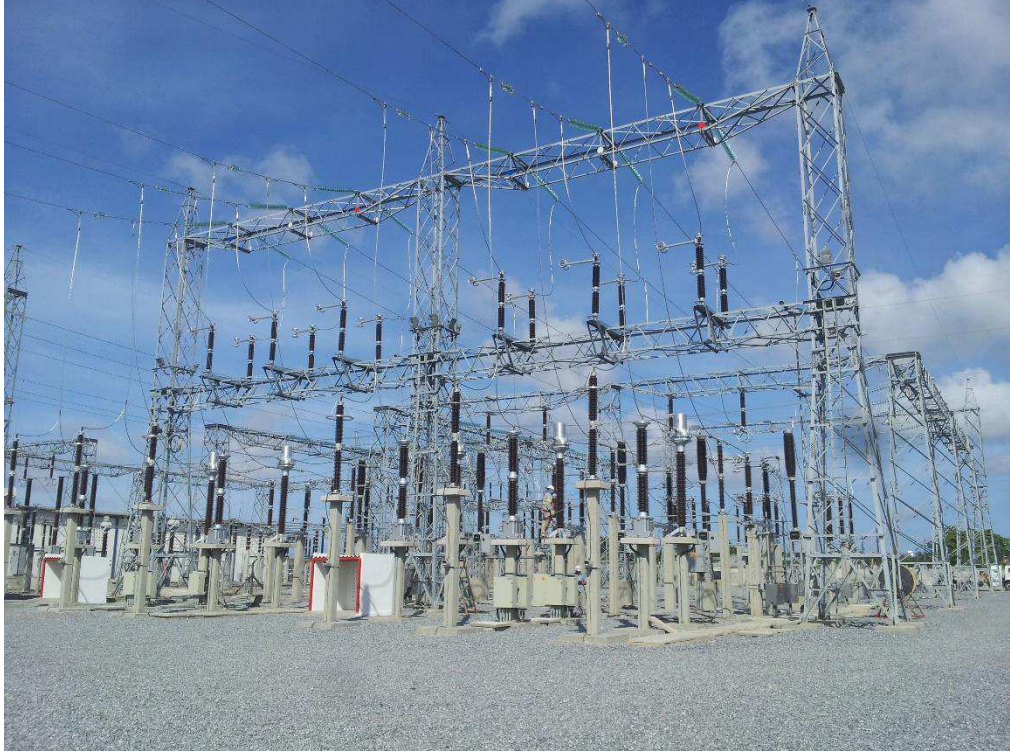
Figura 18. Subestação seccionadora de 230 kV
