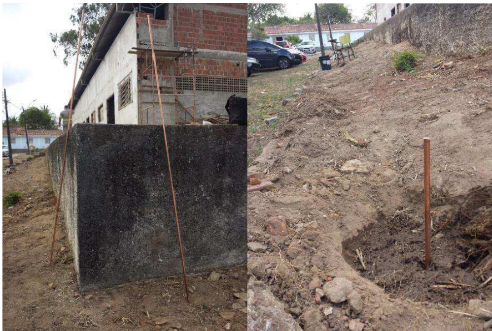
FIGURA 13 HASTES DE ATERRAMENTO
