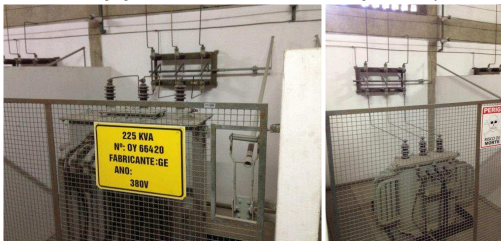
Fig. 30. (a) Destaque para transformador, barramento e a chave seccionadora. (b) Destaque para o barramento e o transformador com dique de contenção.
