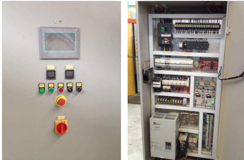
Fig. 14. (a) Parte frontal do quadro de comando. (b) Parte interna do quadro de comando.
