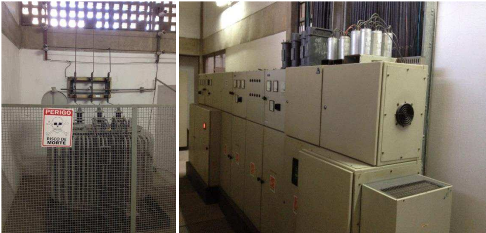
Fig. 31. (a) Transformador com chave seccionadora. (b) Painéis de média e baixa tensão.
