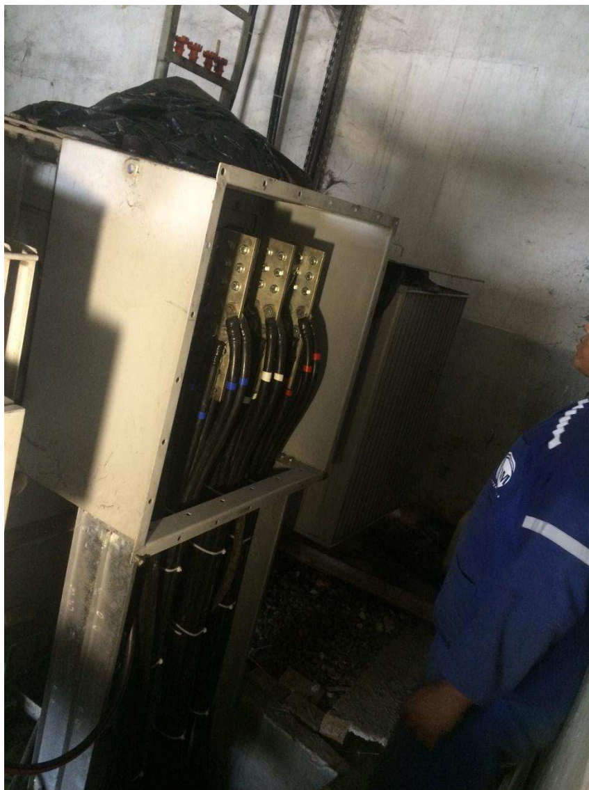
Figura 47 – Fases do trafo de 13,8 kV da casa de força antiga.
