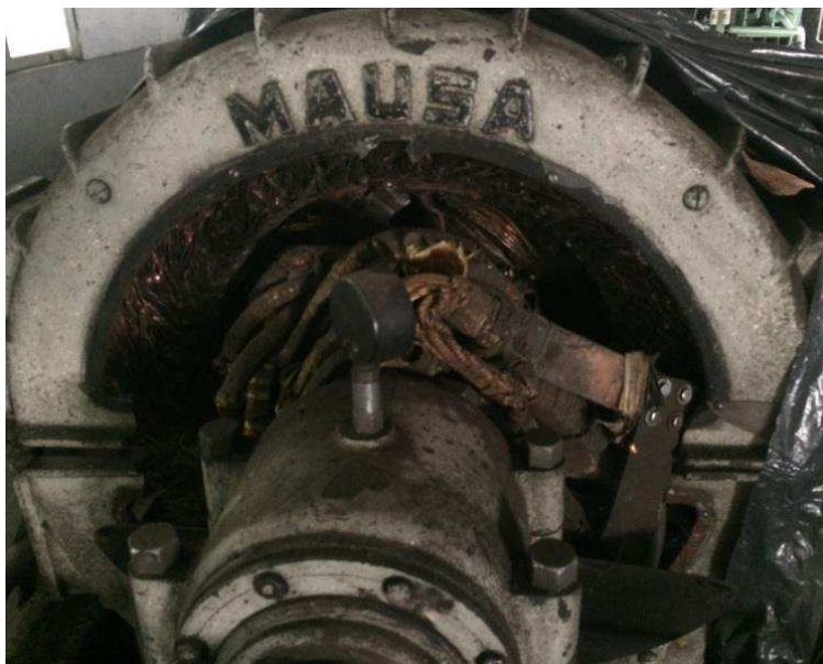
Figura 31 – Gerador com defeito que foi substituído.
