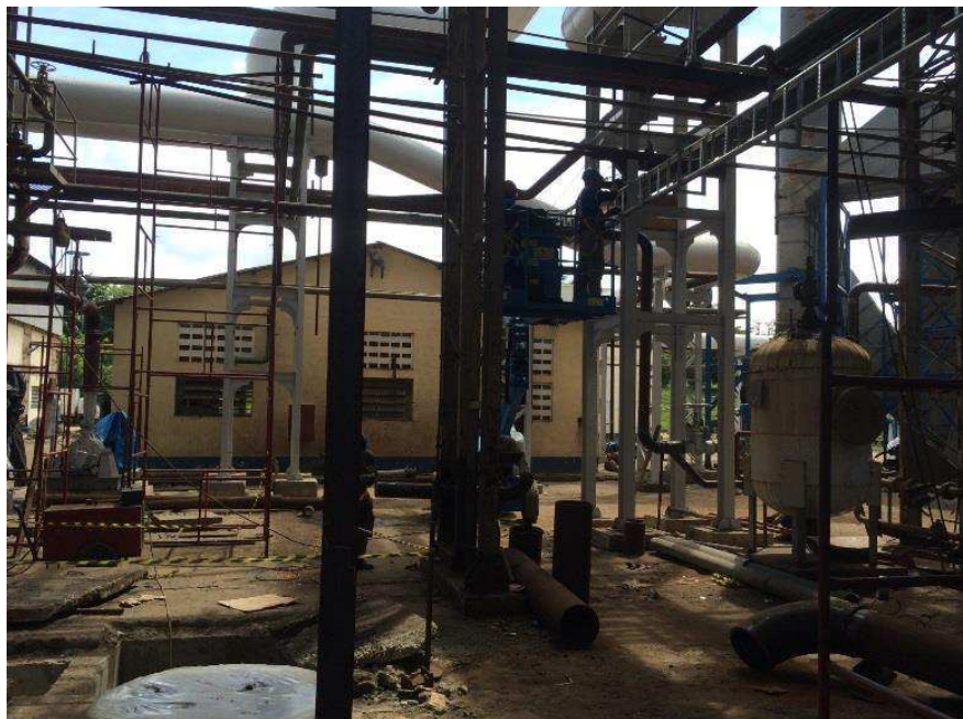
Figura 42 – Pipe rack entre a fabricação e a caldeira.
