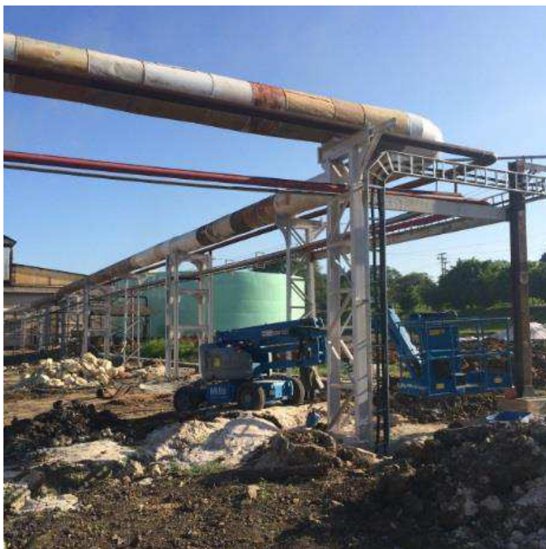
Figura 44 – Pipe rack proximo a destilaria.
