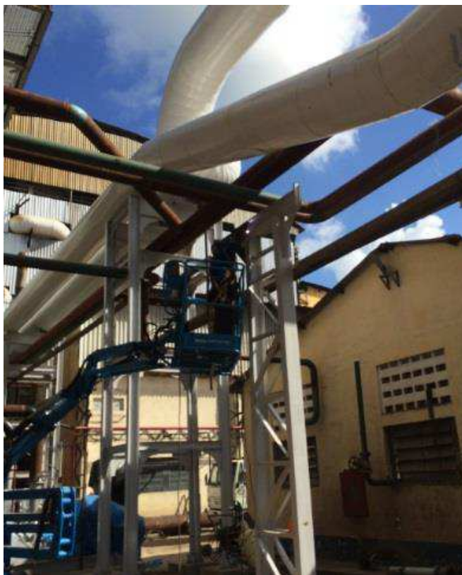
Figura 43 – Pipe rack do lado da casa de bombas.
