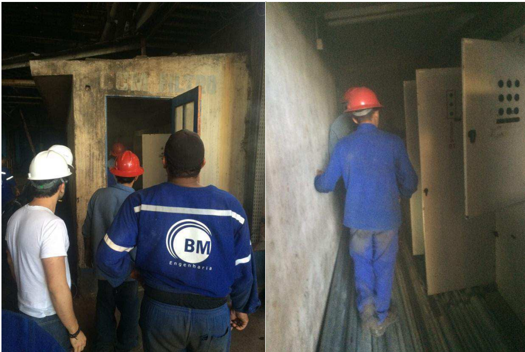
Figura 48 – Princípio de incêndio ocasionado por um curto.
