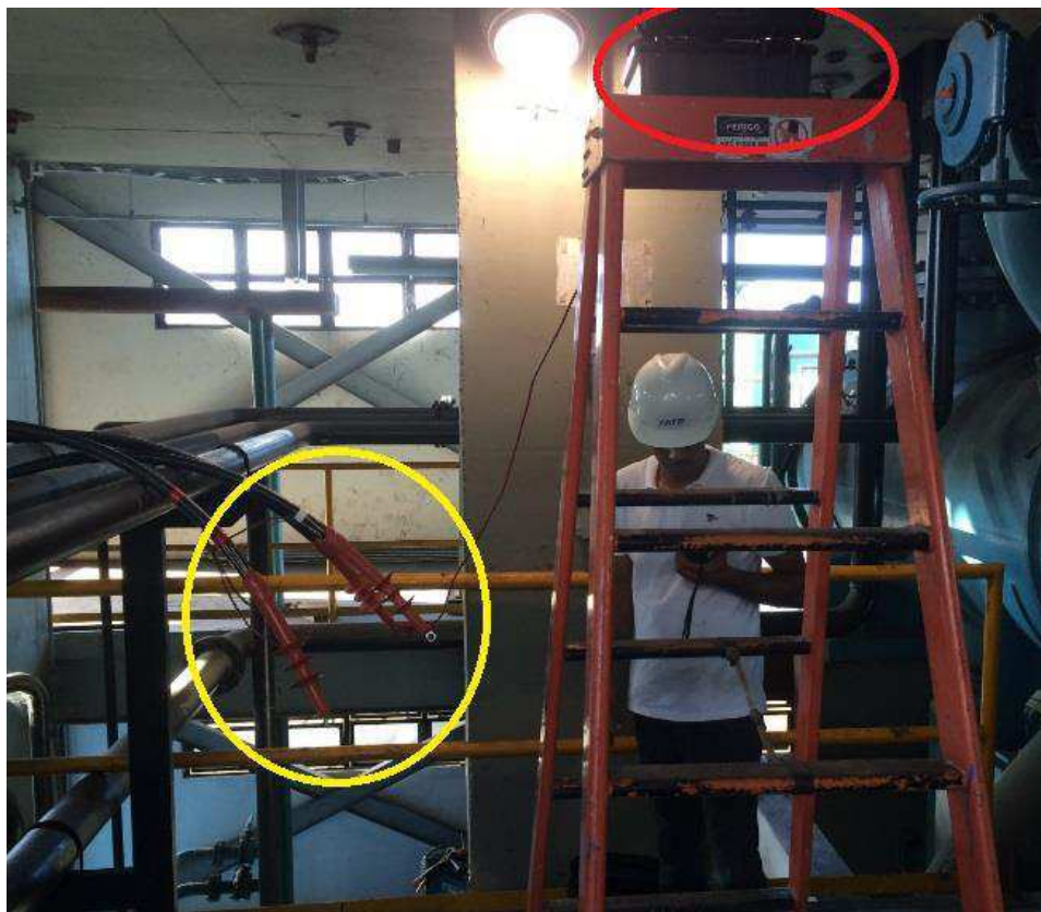
Figura 37 – Teste megger em cabos de mt na casa de força nova.
