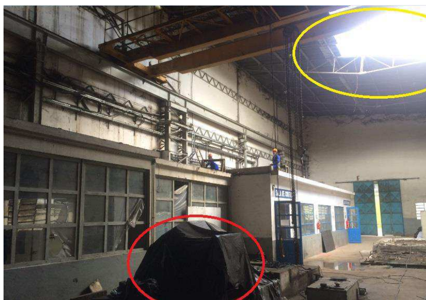
Figura 32 – Edificação pos explosão do gerador.
