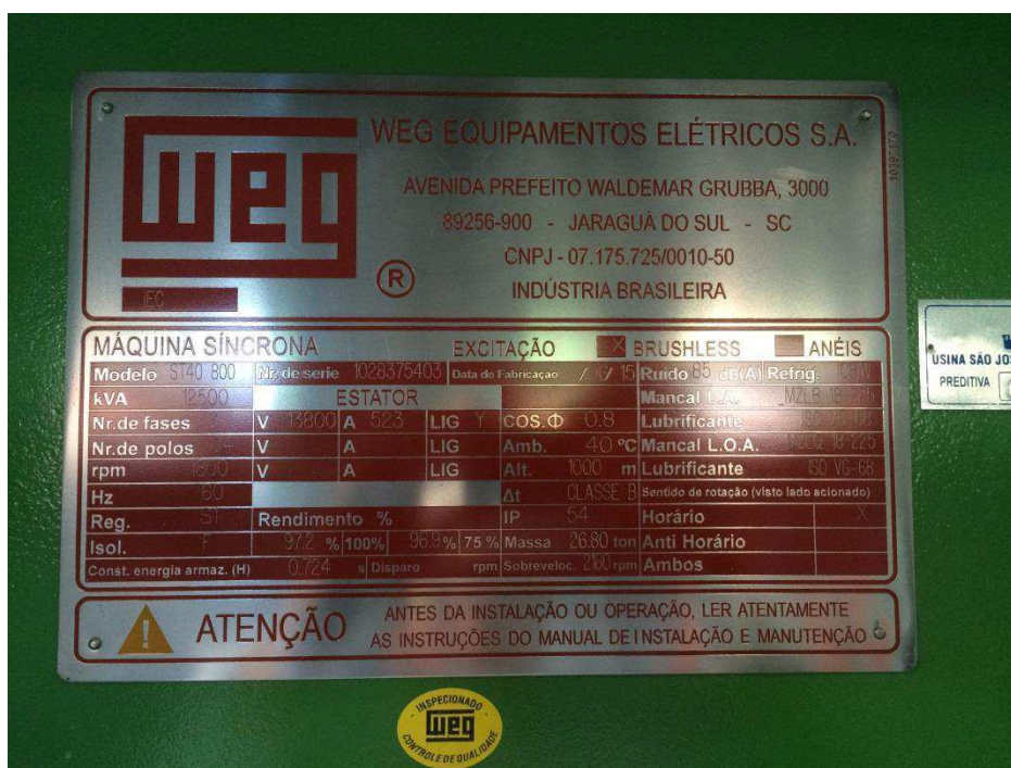
Figura 40 – Placa do gerador 4.
