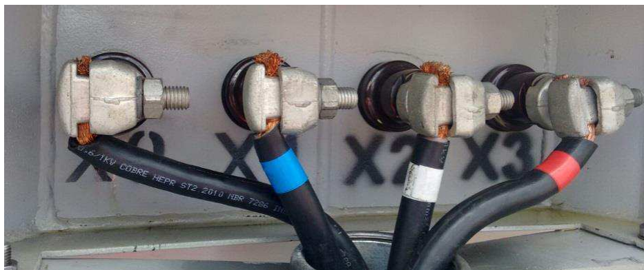
Figura 26 – Vazamento na bucha X0 do TSA.
