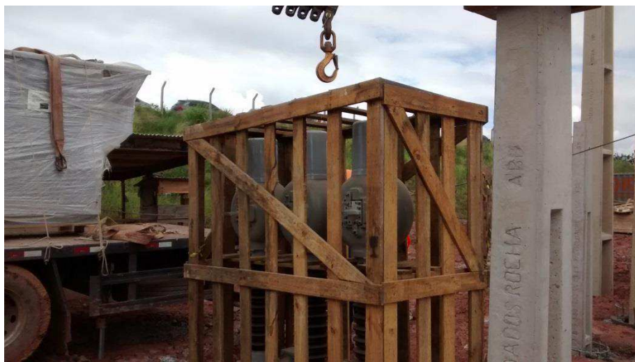
Figura 17 – Retirada dos tc's de proteção do munk para serem colocados no local.
