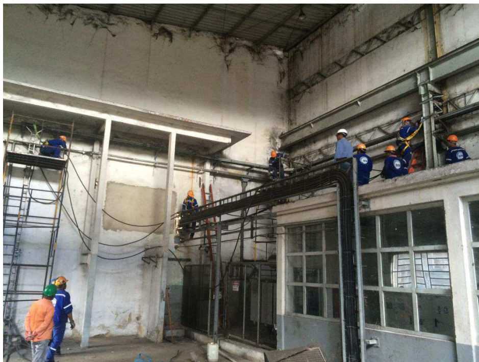
Figura 34 – Remoção dos cabos de MT da casa de força antiga para serem reaproveitados.
