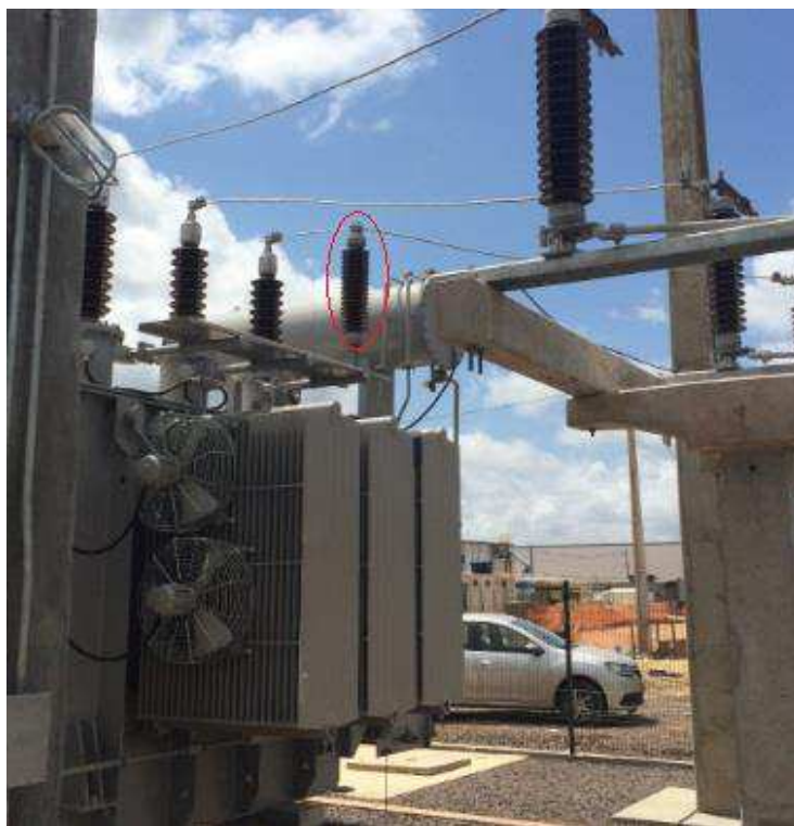
Figura 24 – Isolador para-raio instalado na bandeja do trafo 1.
