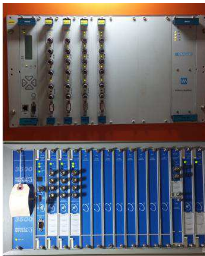
FIGURA 5: MEDIDORES DE VIBRAÇÃO
