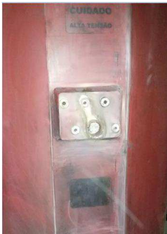
FIGURA 78: TRANSFORMADOR APÓS LIMPEZA
