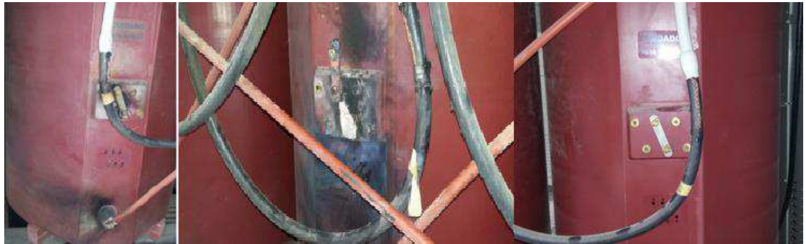
FIGURA 16: BOBINAS ANTES DA MANUTENÇÃO
