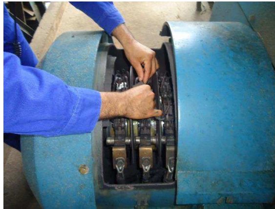
FIGURA 14: SUBSTITUIÇÃO DAS ESCOVAS
