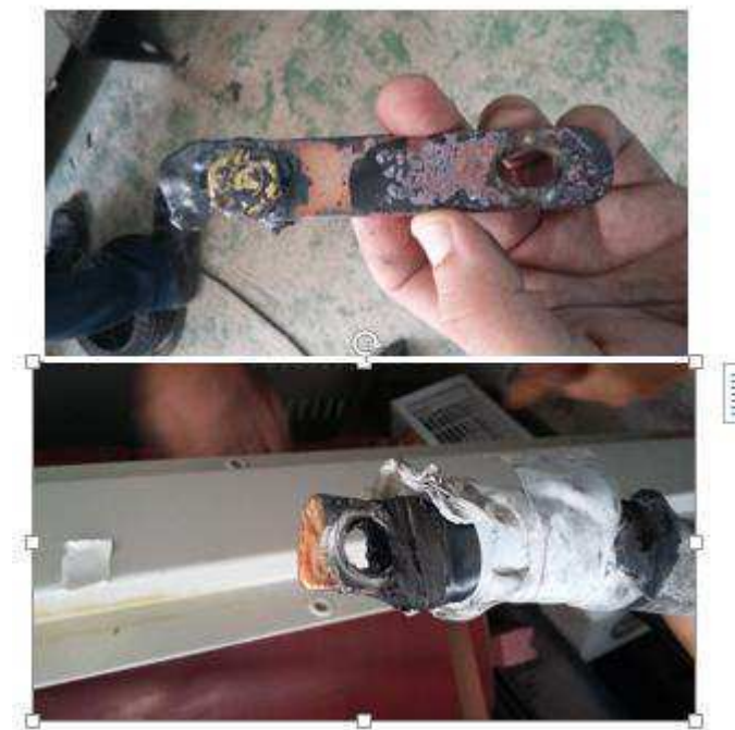
FIGURA 67: BARRA ANTES DA MANUTENÇÃO
