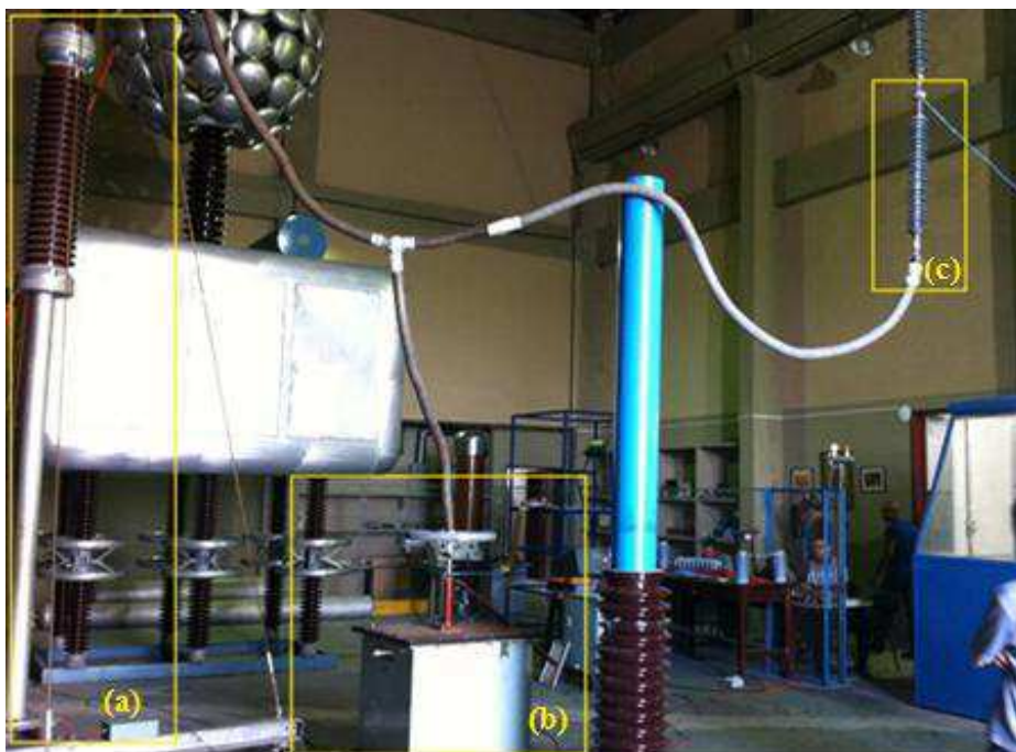
Figura 5: Esquema de montagem para o ensaio em isoladores (a) divisor de tensão capacitivo, (b) gerador de tensão CA e (c) isolador polimérico de alta tensão.
