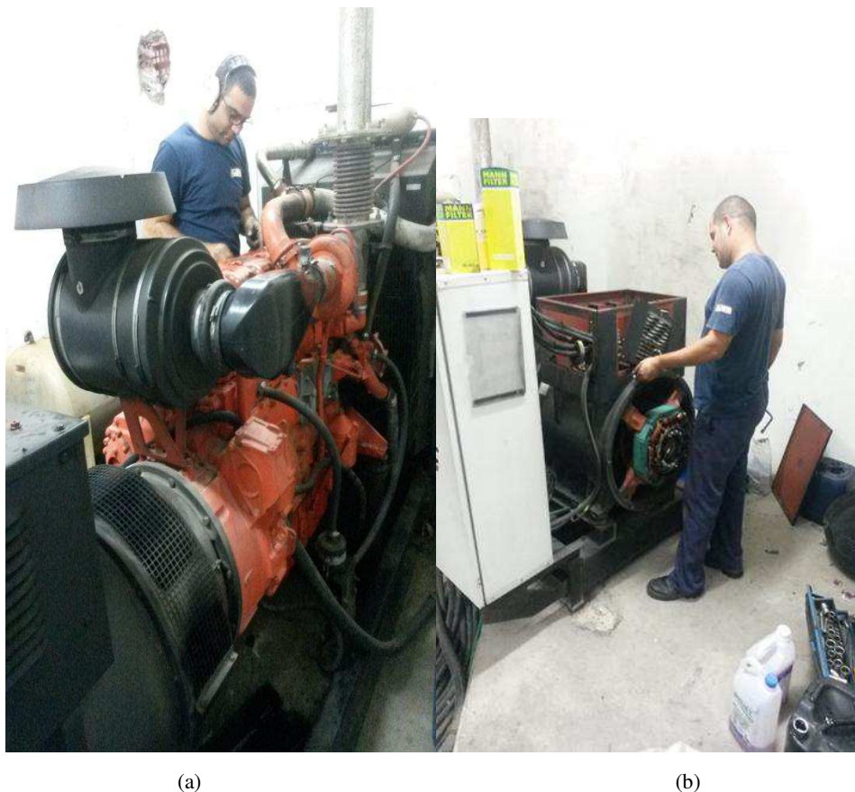
Figura 22 - (a) Foto durante a manutenção preditiva da lubrificação do motor diesel. (b) limpeza da parte externa do GMG.
