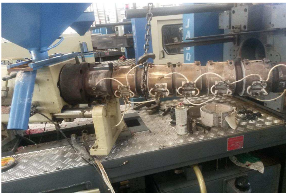
Figura 20 - Foto das zonas de aquecimento da injetora durante a troca das resistências.
