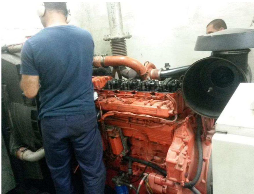
Figura 21 – Foto do acompanhamento da manutenção preditiva no Grupo Motor Gerador (GMG).
