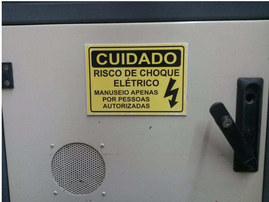
Figura 17 – Foto da sinalização no quadro de comando das injetoras.
