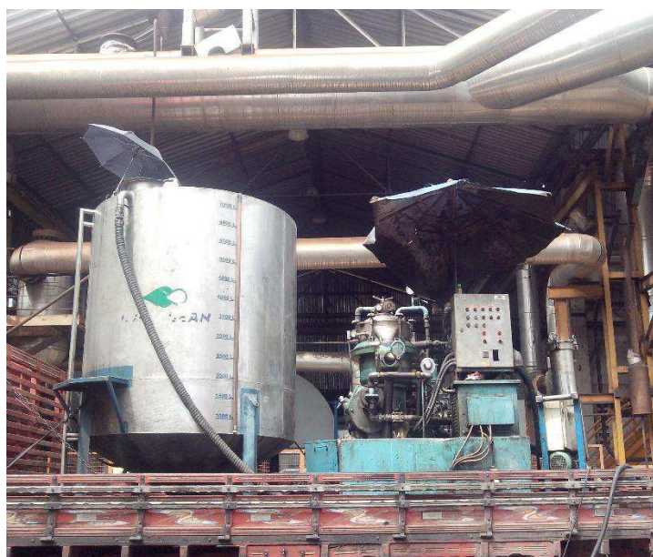
Figura 24 - Filtragem de óleo do gerador.
