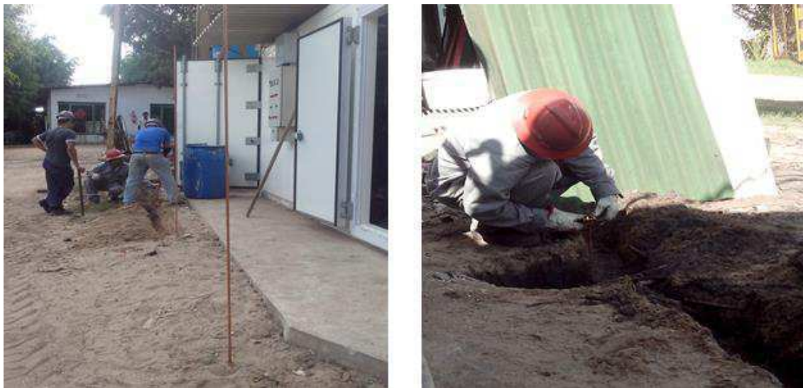
Figura 16 - Aterramento do container gerador de ozônio da destilaria.
