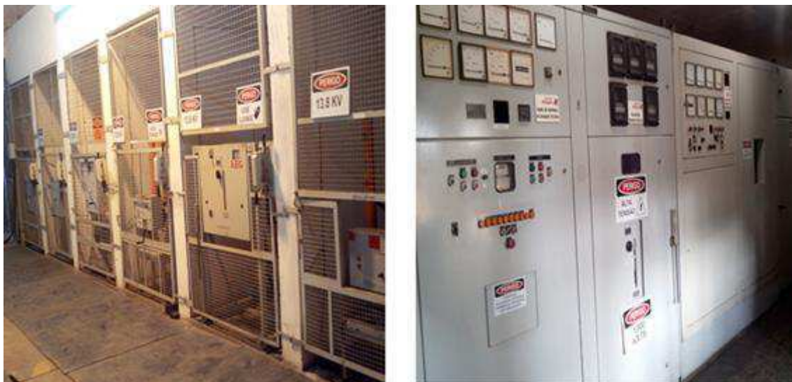
Figura 11 - Subestação 13,8 kV Usina Monte Alegre.
