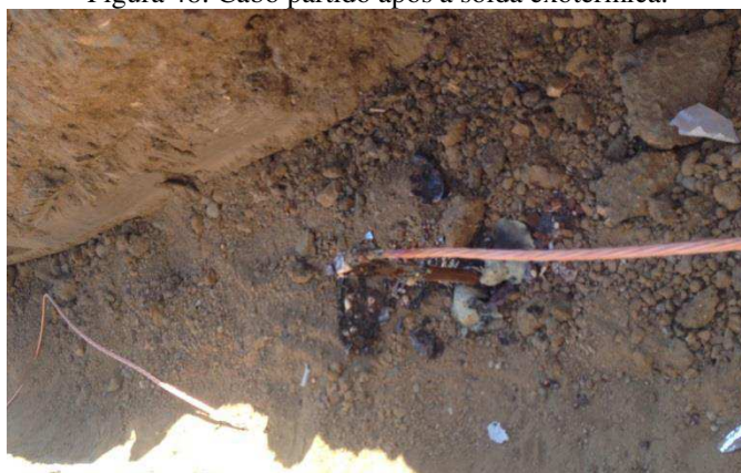
Figura 48: Cabo partido após a solda exotérmica.
