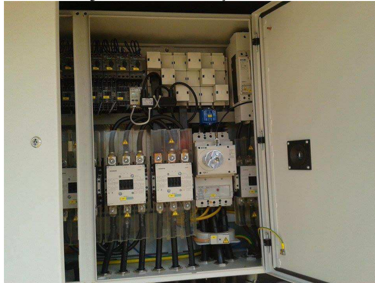
Figura 9: Armário distribuição do MCO11.
