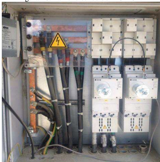
Figura 46: Painel elétrico do MC120Z.
