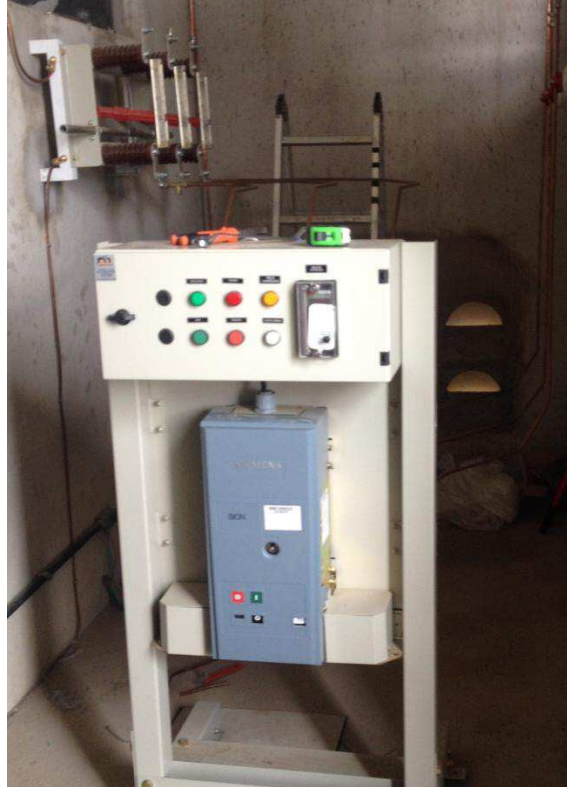
Figura 45: Disjuntor com relé de proteção acoplado.
