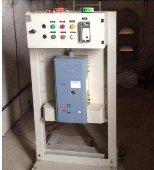
Figura 19: Disjuntor de média tensão.
