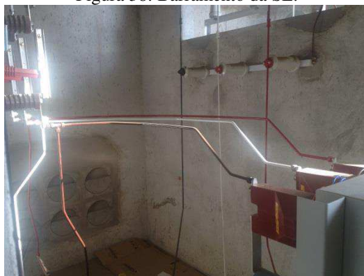
Figura 38: Barramento da SE.
