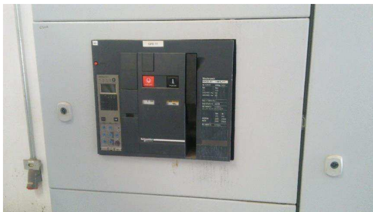
Figura 15 - Disjuntor do quadro principal da subestação.
