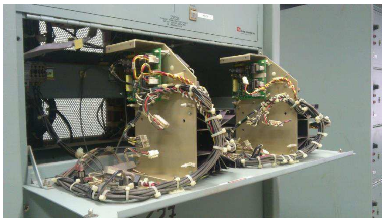
Figura 18 - Retificador com falta de peças.
