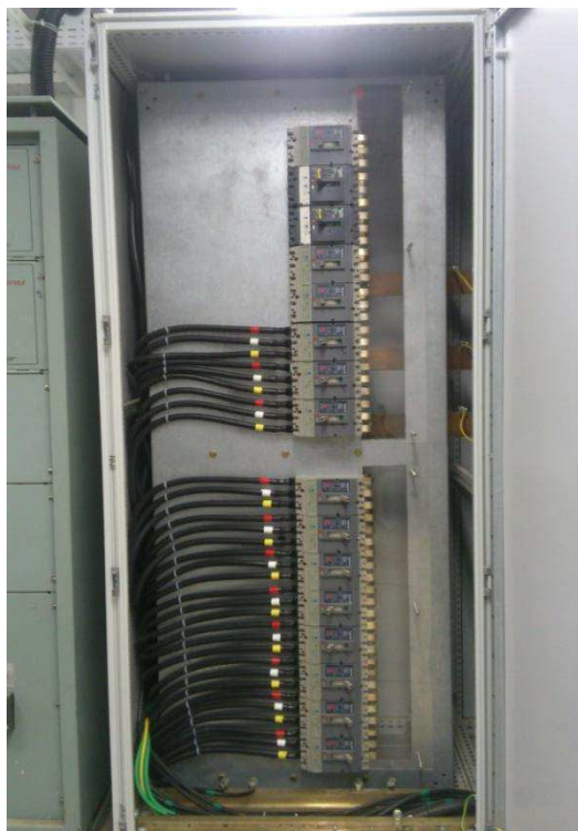
Figura 16 - Quadro com disjuntores.
