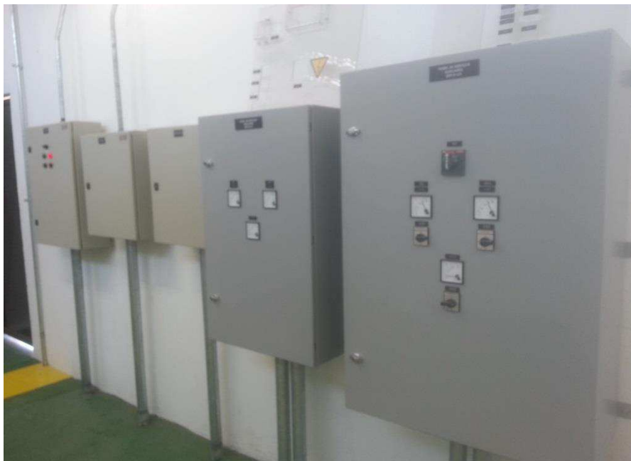
Figura 11 – Quadros de distribuição da casa de comando.
