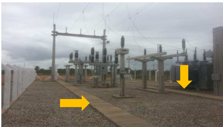
Figura 20 – Disposição das canaletas de BT e MT no pátio da SE.
