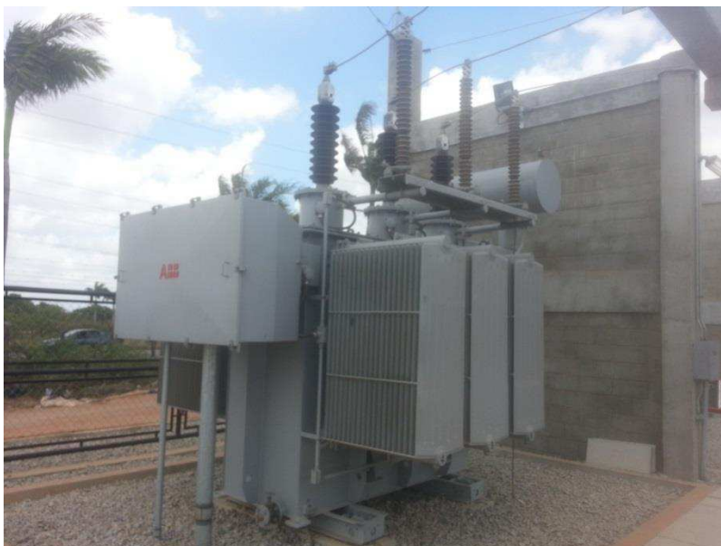
Figura 6 - Modelo do transformador de potência da SE 69/13,8 kV – Fábrica Estrela.
