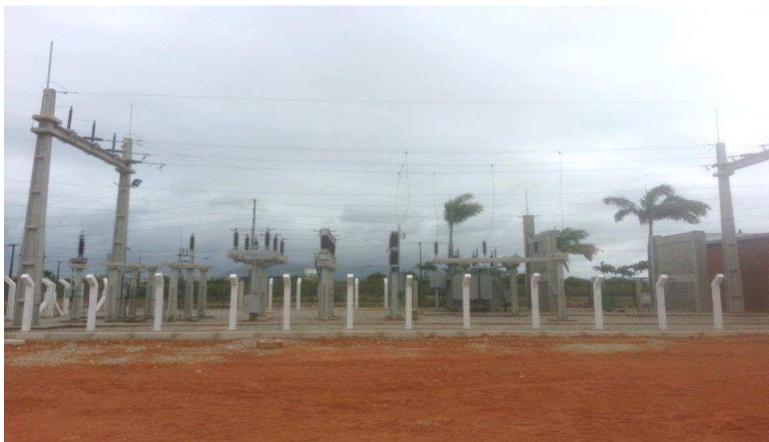
Figura 17 – Vista lateral da SE, com os equipamentos instalados e conectados com o barramento.
