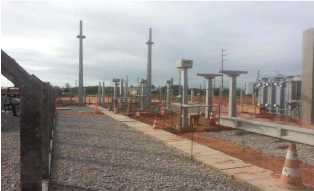
Figura 14 – Estruturas dos equipamentos montadas na SE.
