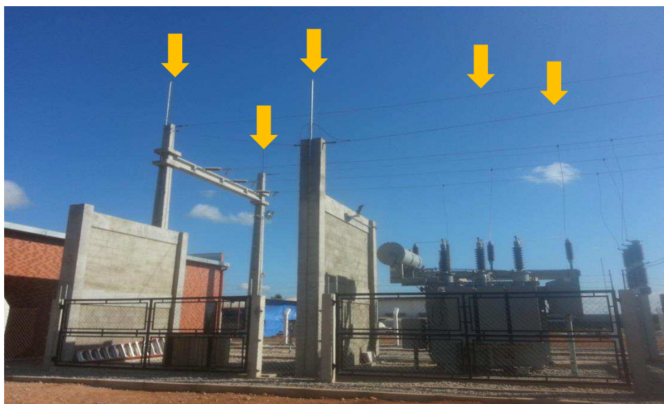
Figura 19 – SPDA da subestação: detalhe de instalação próximo ao transformador.
