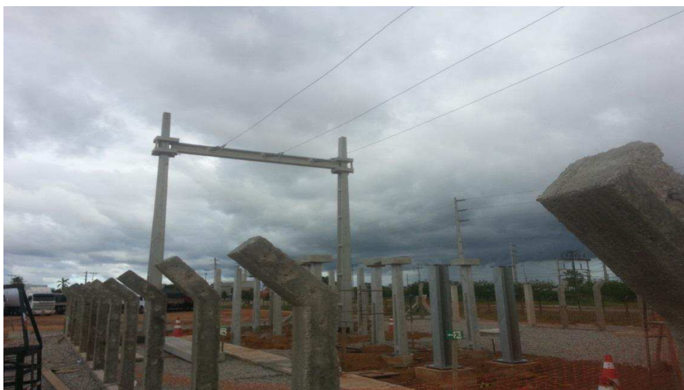
Figura 15 – Barramento da SE.
