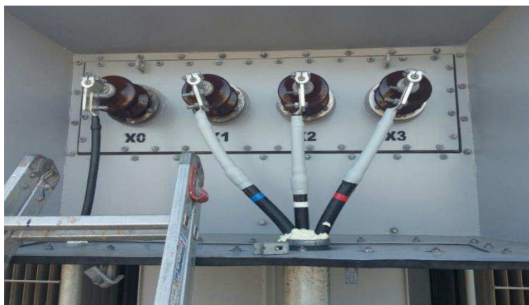
Figura 21 – Saída de MT do transformador conectada aos cabos de MT.
