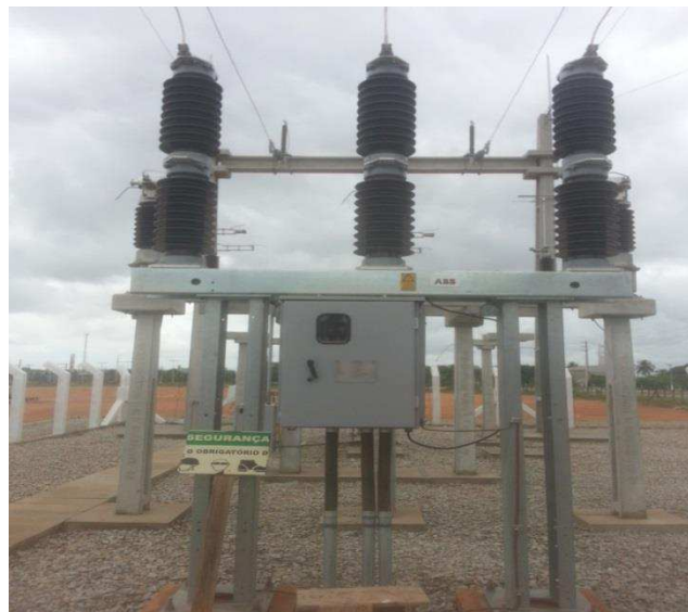
Figura 5 - Modelo do disjuntor da SE 69/13,8 kV – Fábrica Estrela.
