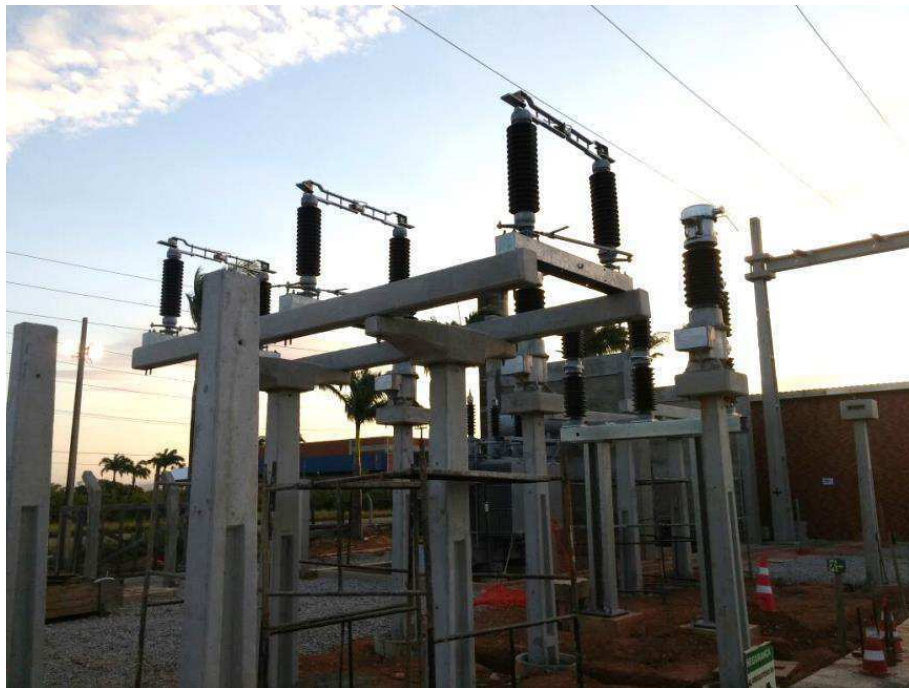
Figura 3 - Modelo da chave seccionadora da SE 69/13,8 kV – Fábrica Estrela.
