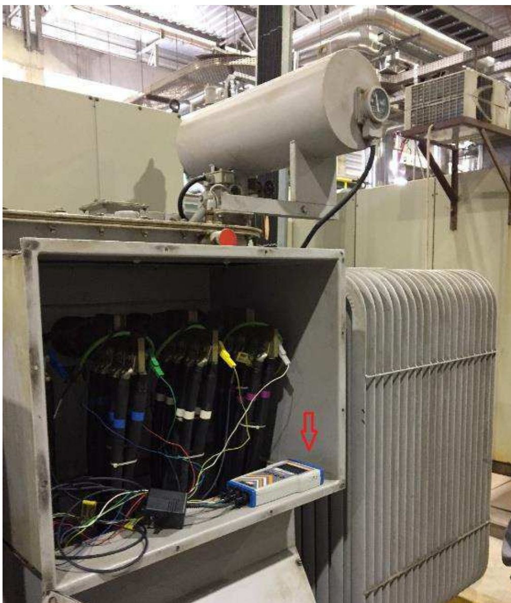
Figura 11 - Medição com uso do registrador realizada no transformador
