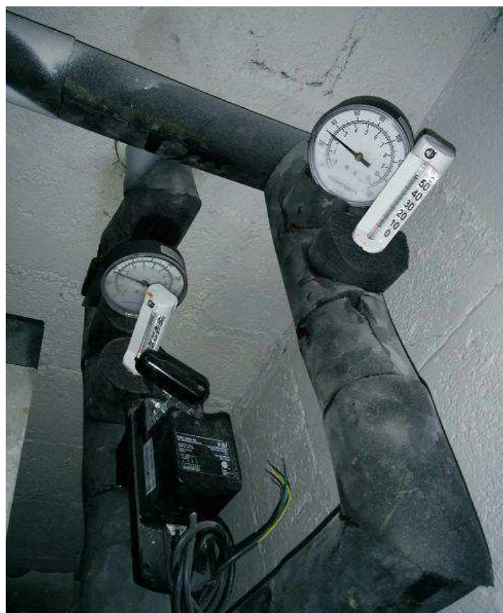
Figura 31: Imagem dos sensores das tubulações conectadas ao fan-coil e válvula de duas vias
