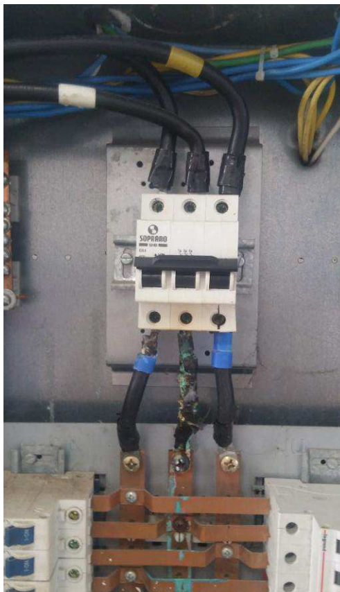
Figura 8. Disjuntor com problema de ponto quente
