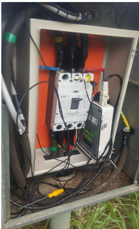
Figura 4. Instalação do analisador trifásico P-600 no Campus VIII.
