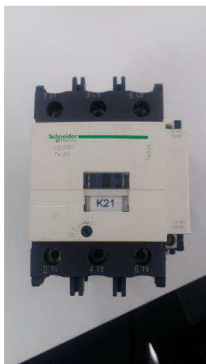
Figura 6. Contactor retirado do compressor.
