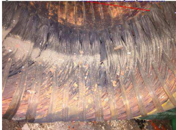
Figura 65: Detalhe do estator com falha por pico de tensão
