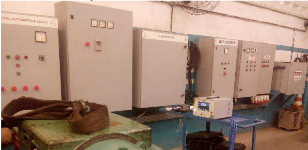
Figura 33: Painéis de Testes de Acionamentos
