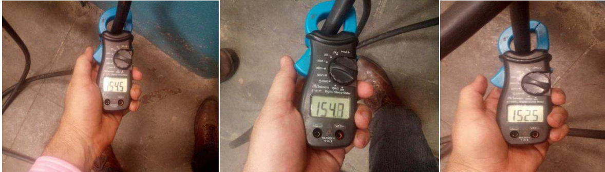
Figura 88: a) Medição de corrente fase 1. b) Medição de corrente fase 2. c) Medição de corrente fase 3
