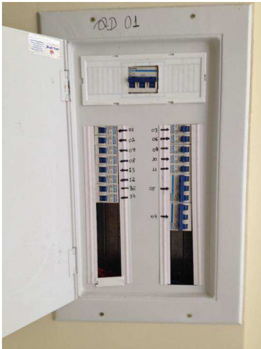
Figura 4.3 - Quadro de Distribuição Térreo.
