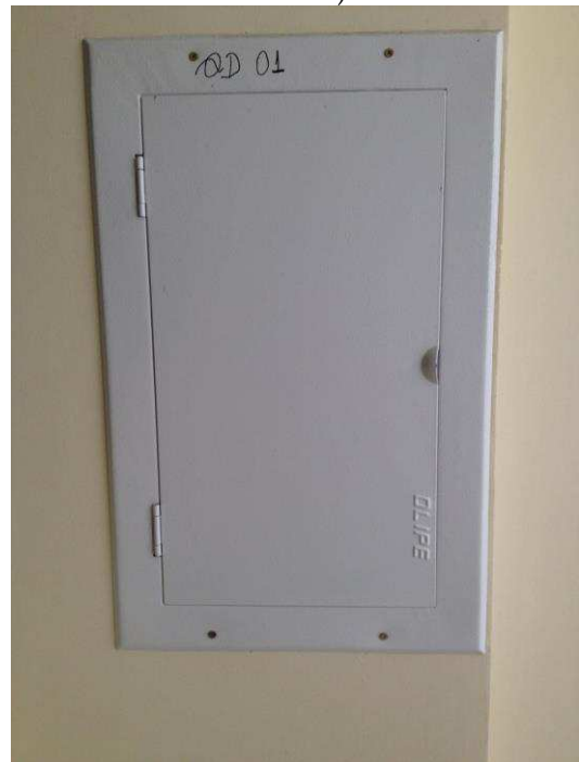
Figura 4.4 - Quadro de Distribuição Térreo (Visão Externa).
