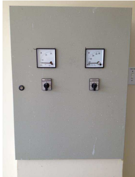
Figura 4.10 – Quadro Geral (Visão Externa).
