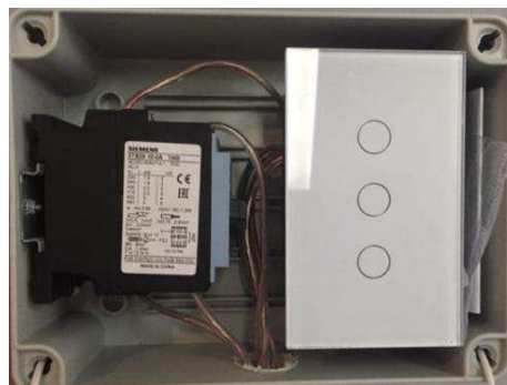
Figura 16 – Interruptor Touchlight e o contactor ligados.
