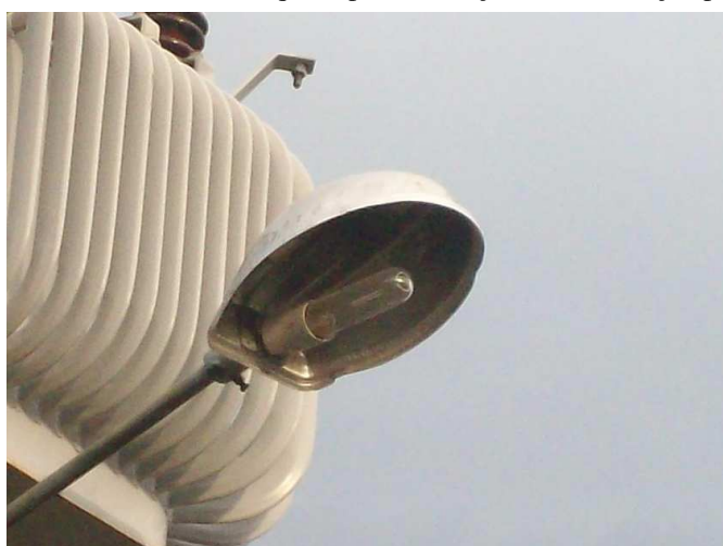
Figura 7 – Luminária inadequada para utilização em iluminação pública.
