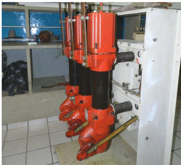
Figura 4.1: Fotografia do disjuntor A.
