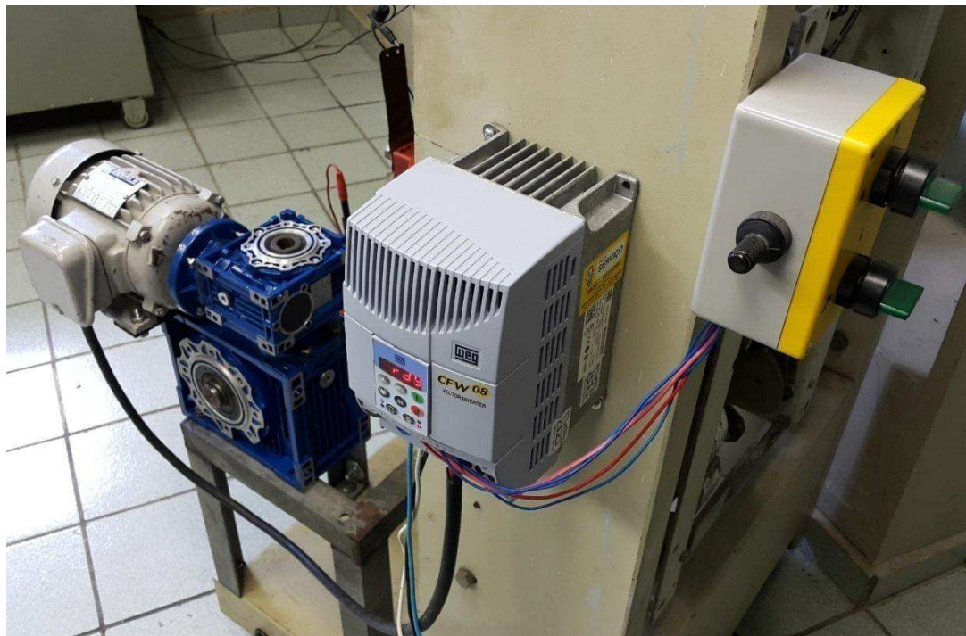
Figura 4.7: Sistema de redução/controle de velocidade de abertura dos contatos.
