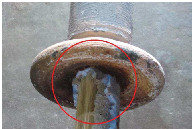
Figura 5.6. Fotografia da junção entre núcleo e terminal em condição extrema de degradação, destacado dentro do círculo vermelho.
