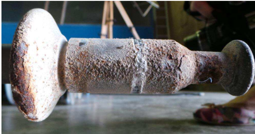
Figura 5.4. Fotografia da corrosão das ferragens, destacadas em primeiro plano.
