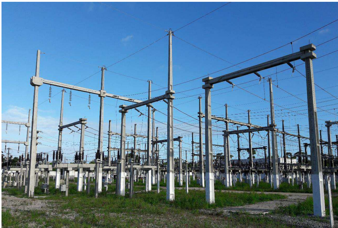
Figura 12: Equipamentos instalados, mas não conectados
