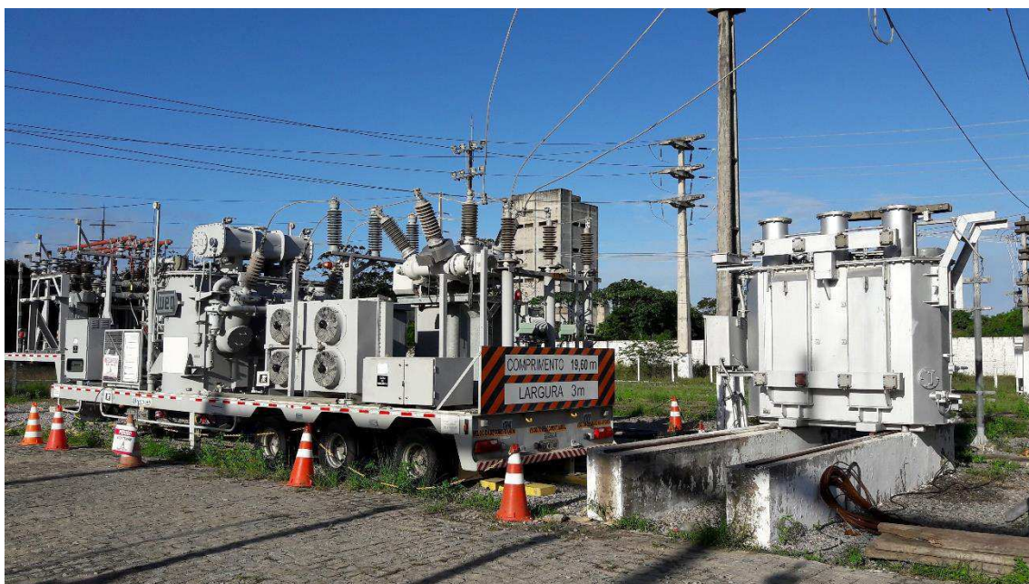
Figura 9: Subestação móvel ao lado do transformador defeituoso.
