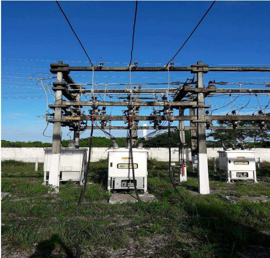
Figura 11: Chave seccionadora 13,8 kV
