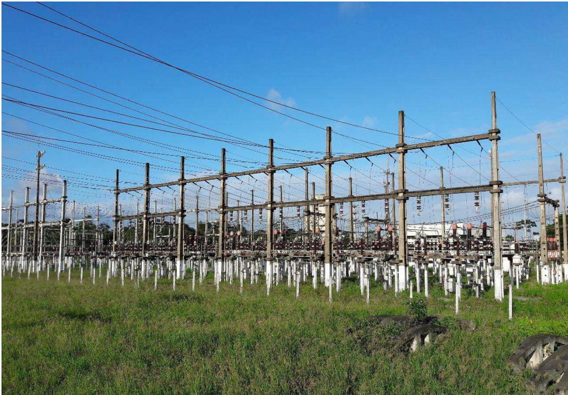
Figura 7: Subestação Polo Cloroquímico (PCA)
