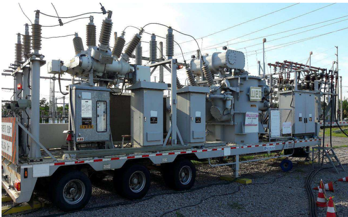
Figura 10: Equipamentos que compõem a subestação móvel.
