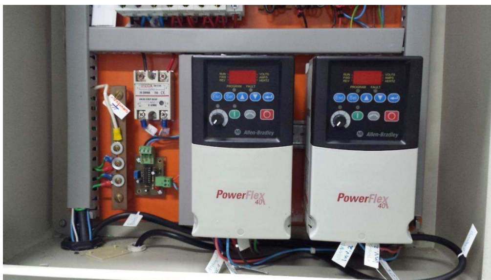
Figura 10 - Posicionamento do novo Inversor (à direita)
