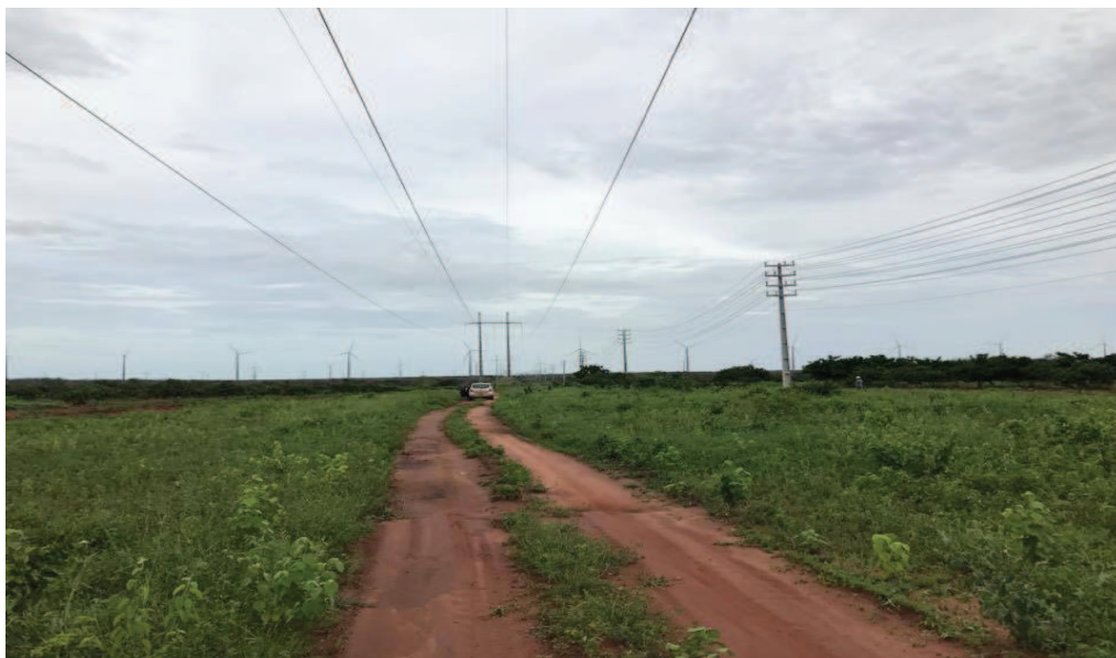
FIGURA 8: LT 230KV E RAMT 34,5KV
