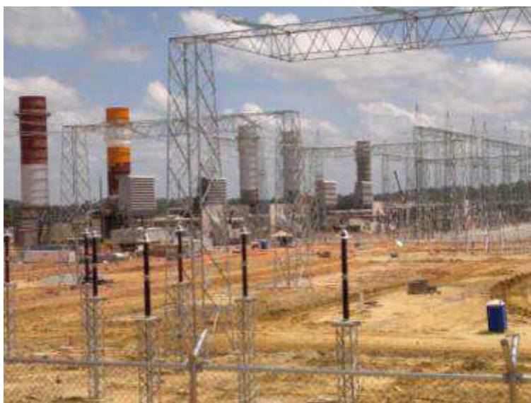
Figura 3 - Subestação Parnaíba II (SE INITEC) – 500 kV
