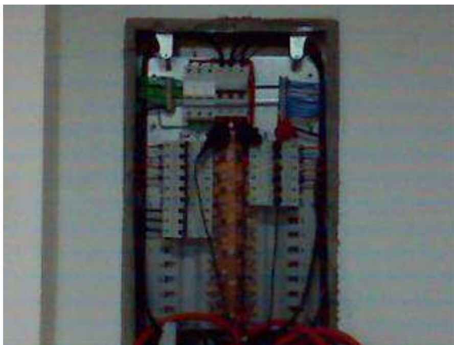
Figura 13– Imagem luz visível do QGBT do piso inferior da residência
