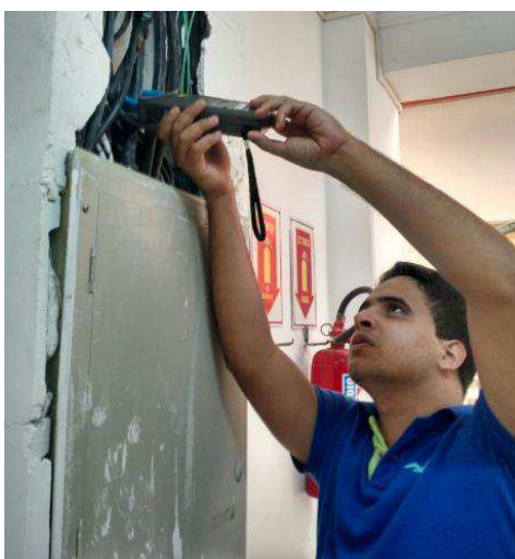
Figura 14: Medição de corrente no quadro geral de baixa tensão.
