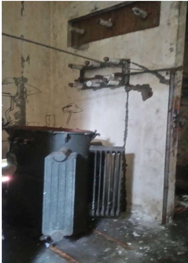
Figura 6 - Carcaça de transformador e isoladores abandonados.
