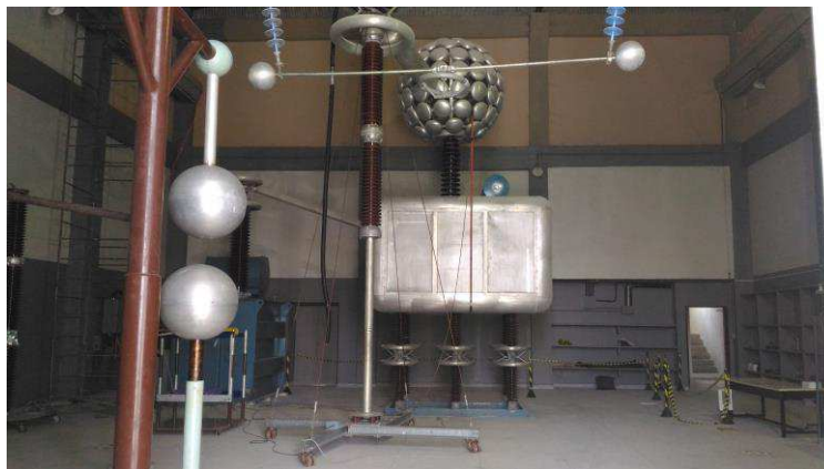
Figura 1. Salão de Alta Tensão.
