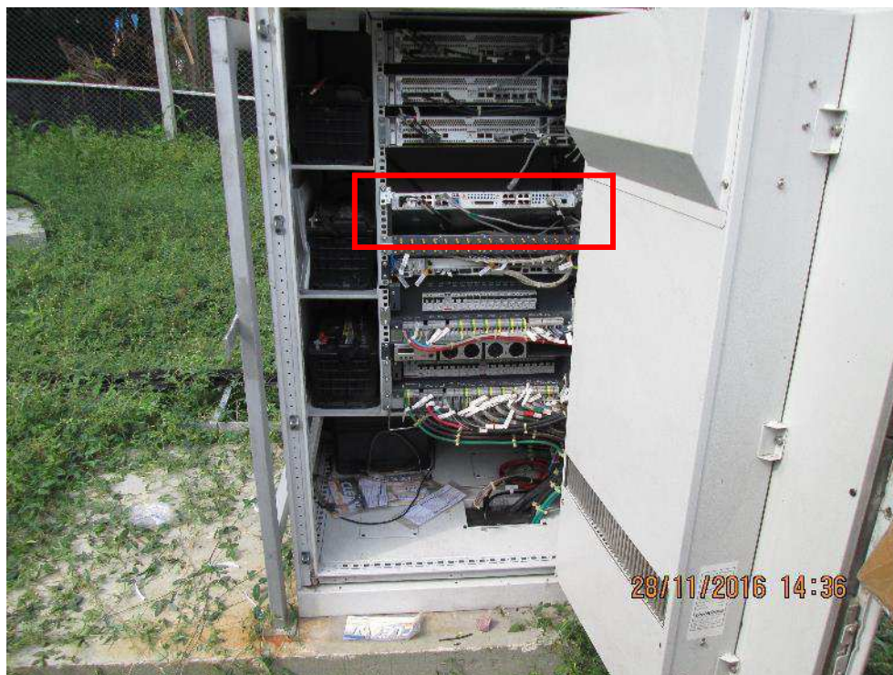
Figura 3 - Vista do gabinete após instalação
