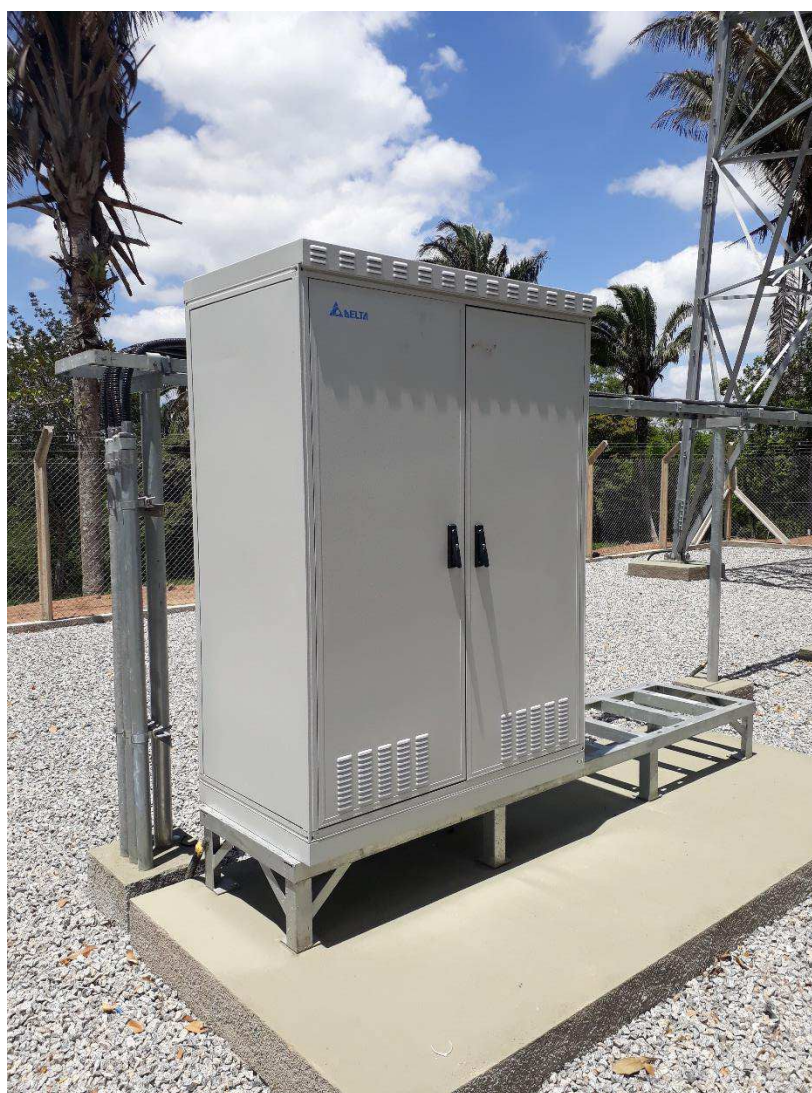
Figura 12 - Gabinete DELTA instalado
