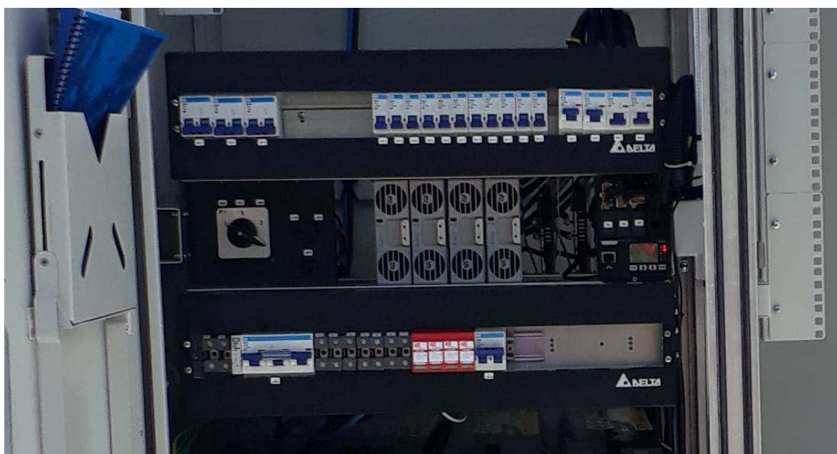
Figura 14 - Retificadores e disjuntores
