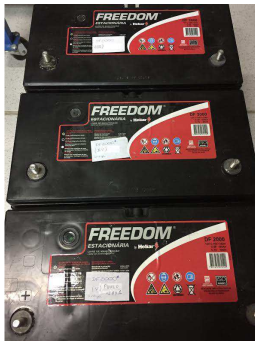
FIGURA 4: BATERIAS UTILIZADAS NOS TESTES.
