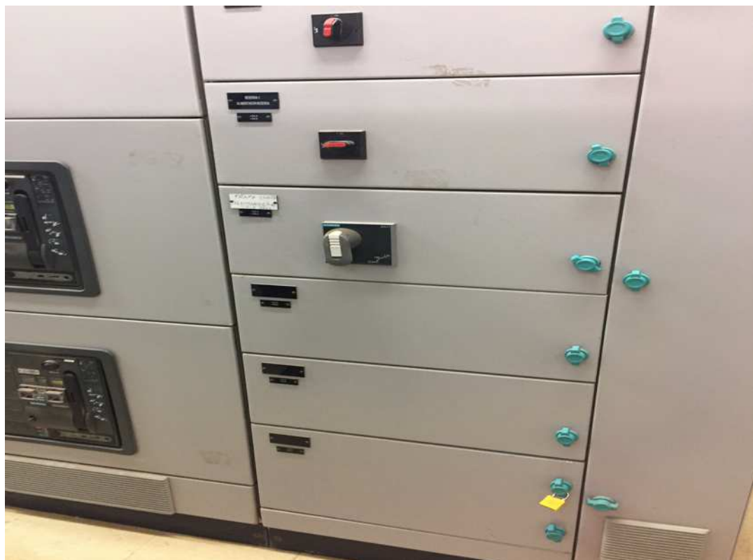
Figura 15 – Gavetas vagas do barramento de emergência do Painel QSA
