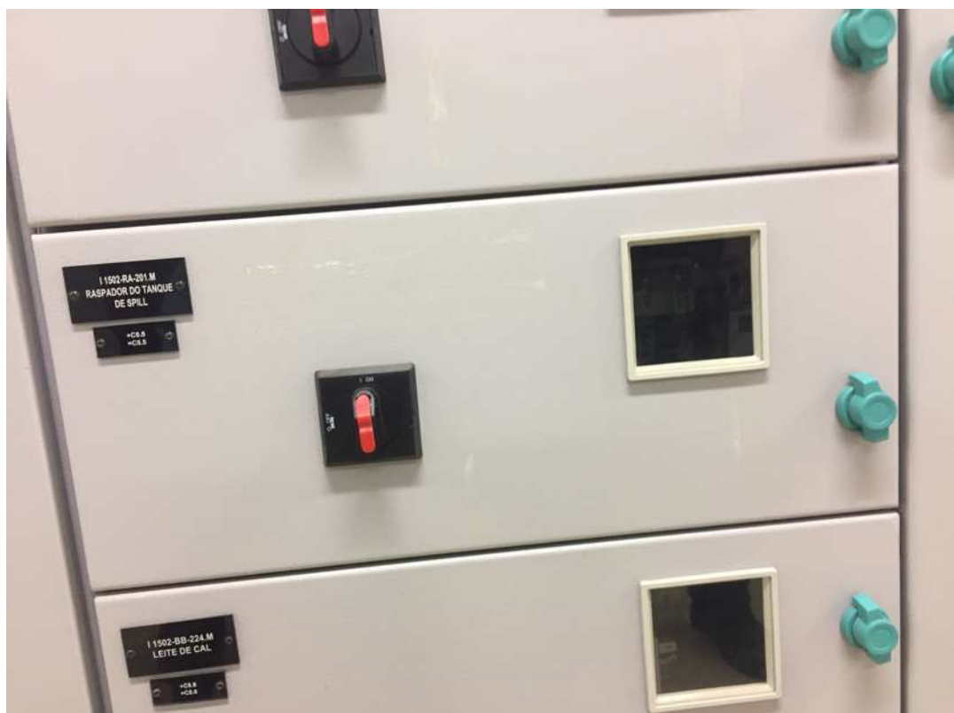
Figura 17 – Gaveta do raspador do tanque spill
