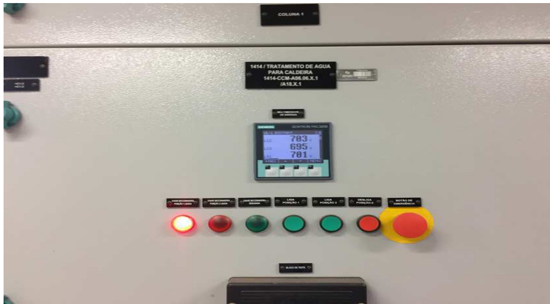
Figura 12 – Painel CCM em que se encontra a bomba de água de selagem
