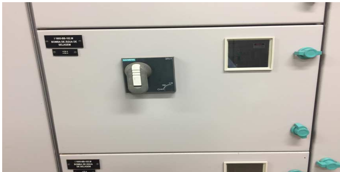
Figura 13 – Gaveta da bomba de água de selagem I 1605-BB-102M
