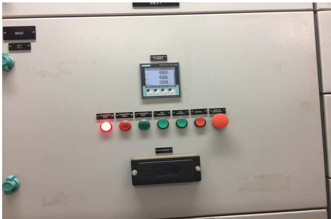
Figura 14 – Painel QSA (1414-QSA.A06.6.X.1/A18.X.1) em que se encontra a barra de emergência
