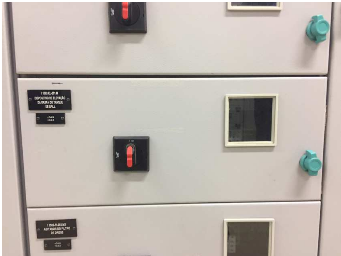
Figura 16 – Gaveta do dispositivo de elevação de raspas do tanque spill
